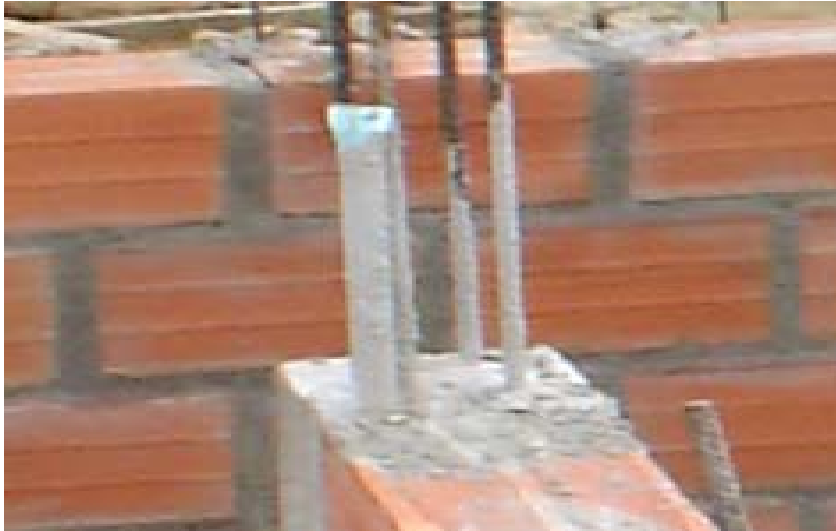
Figura 27. Tubo eléctrico en la columneta.
