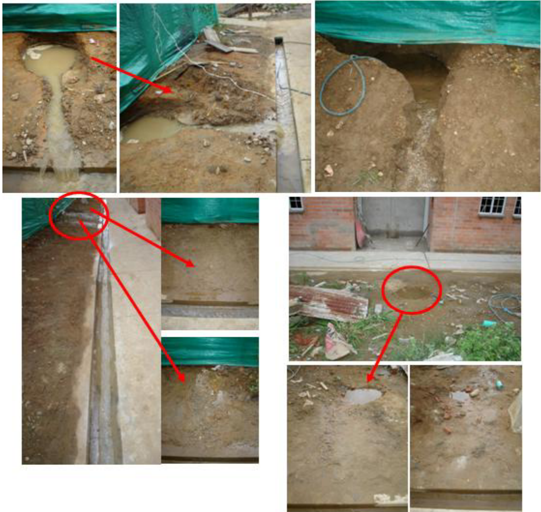
Figura 8. Registro fotográfico/ fugas de agua en las domiciliarias alrededor de la manzana L/ Fase III.
