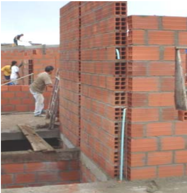
Figura 43. Ubicación tubería eléctrica.
