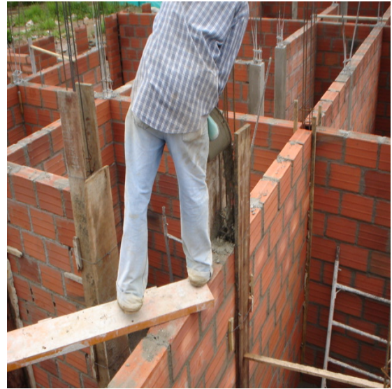
Foto 2: Se aprecia la formaleta y el vaciado del concreto de 3000 psi para las columnetas del primer piso.
