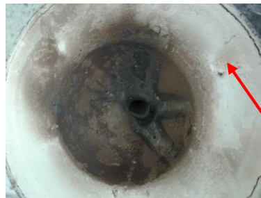
Agrietamiento del molde
