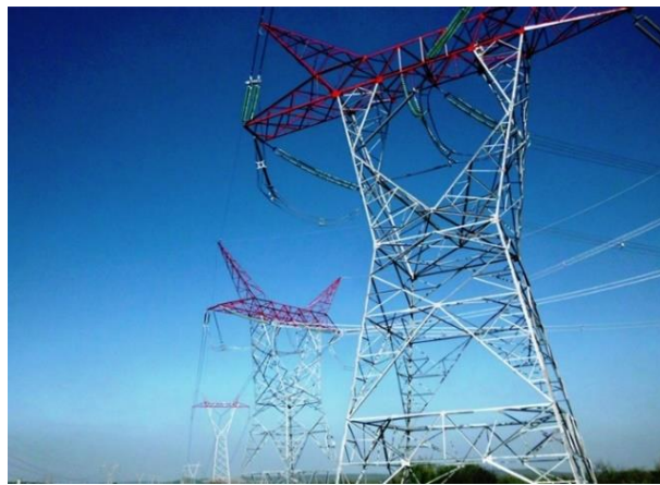
Figura 9. Línea de transmisión de 500 kV, estructura en ángulos Adaptado de acero ATD, (2019). Torres para líneas de transmisión.
