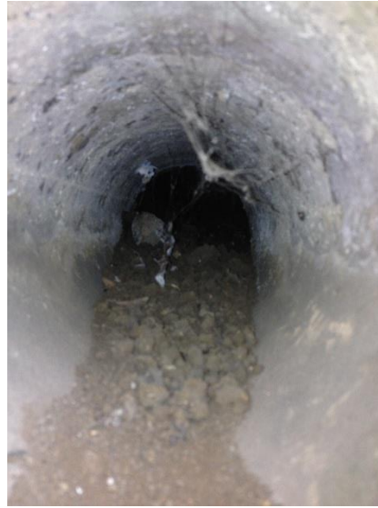
Figura 8. Sedimentación de finos dentro del subdren horizontal.
