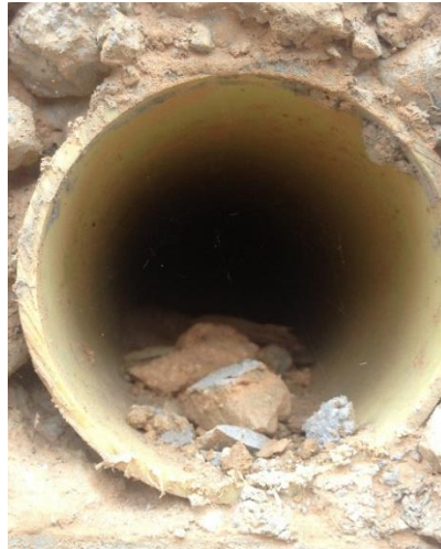
Figura 11. Subdren de penetración con sedimentos y desechos acumulados
