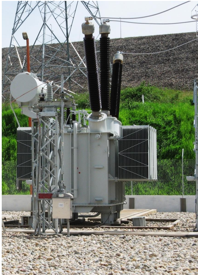
Figura 21, Reactor de Potencia de la Subestación Betania
