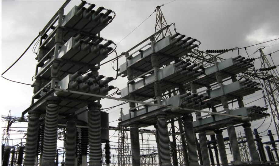
Figura 23, Banco de Condensadores 1 de la Subestación Tunal
