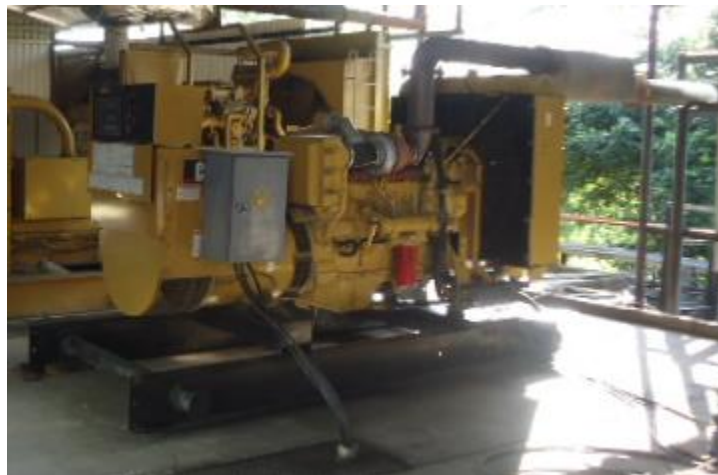
Figura 12: Generador a Diésel CATERPILLAR 3406.
