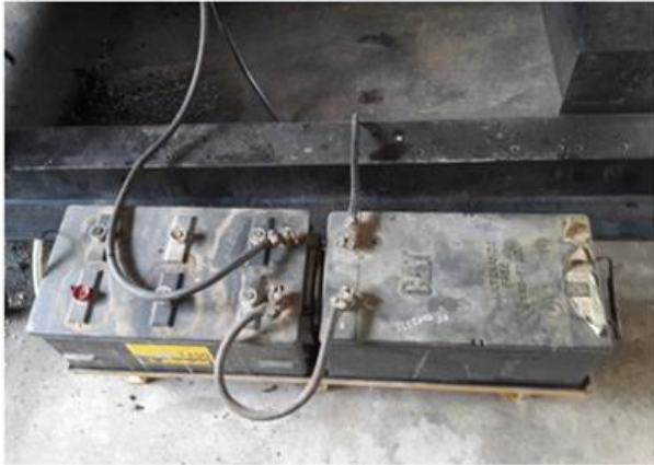
Figura 43: Baterías con suciedad del Generador Primario.
