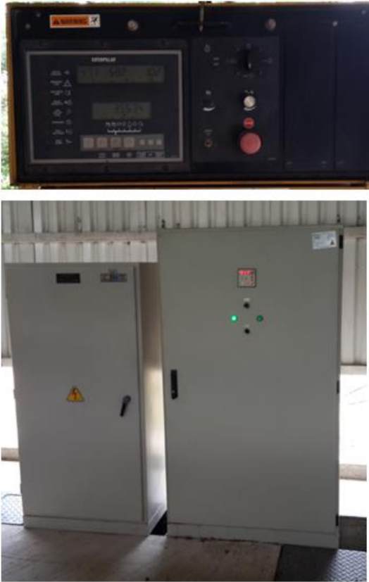
Figura 44: Tableros de control y distribución.
