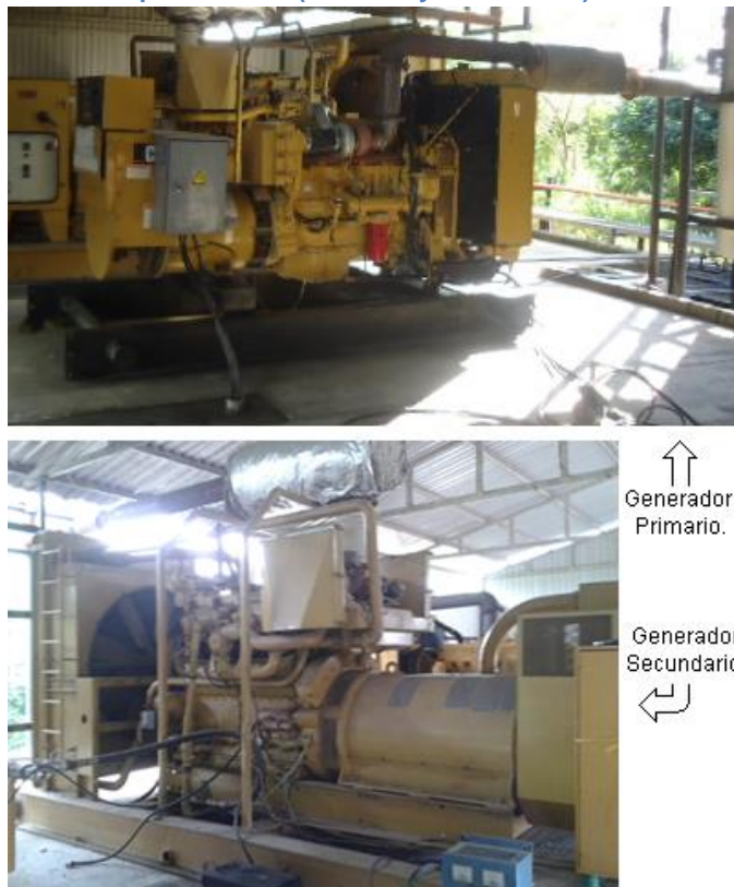
Figura 42: Generadores del Campo Tilodirán (Primario y Secundario).
