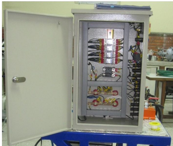
Figura 51. Tablero de control y marcación por anillos numerados.
