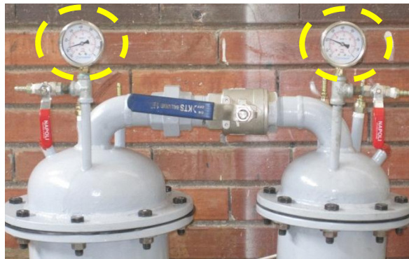
Figura 54. Ubicación de los vacuómetros en los tanques del proceso principal.
