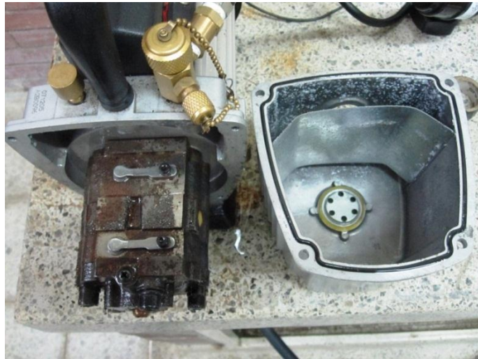
b) Drástico deterioro de la bomba de vacío.
