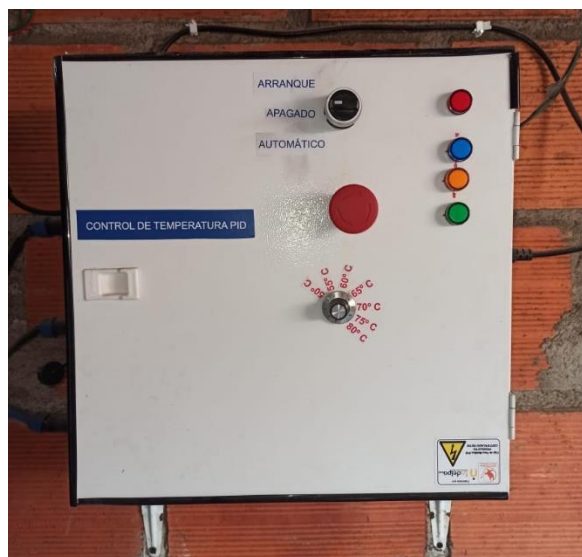
Figura 50. Caja de control Instalada.
