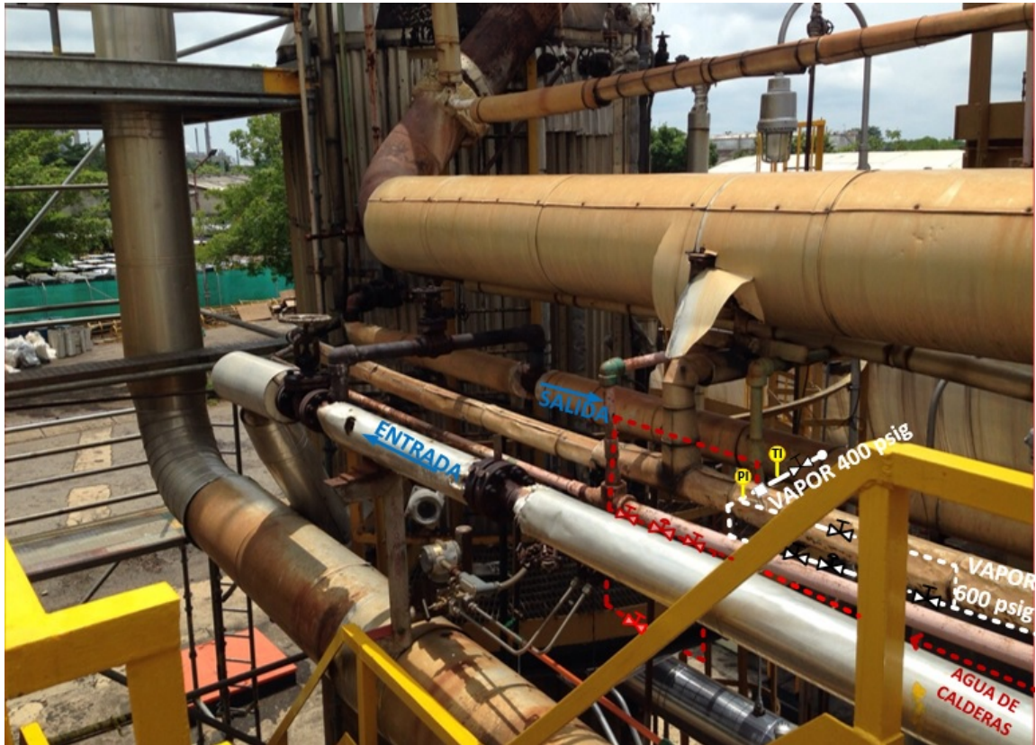
Figura 10. Válvulas de control de presión y temperatura propuestas
