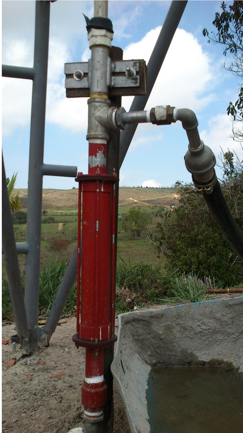
Figura 67. Bomba TOBO instalada
