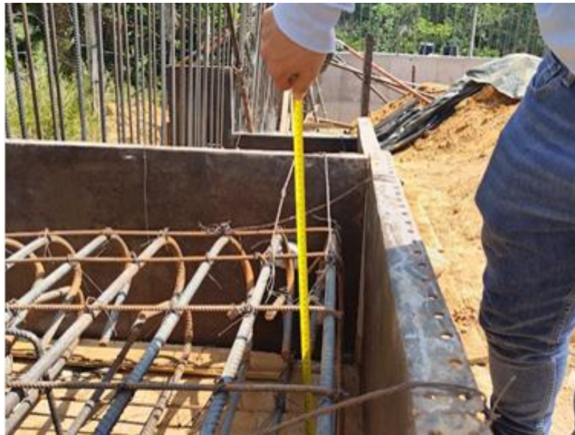
Figura 5 Visita a subestación Yariguies
