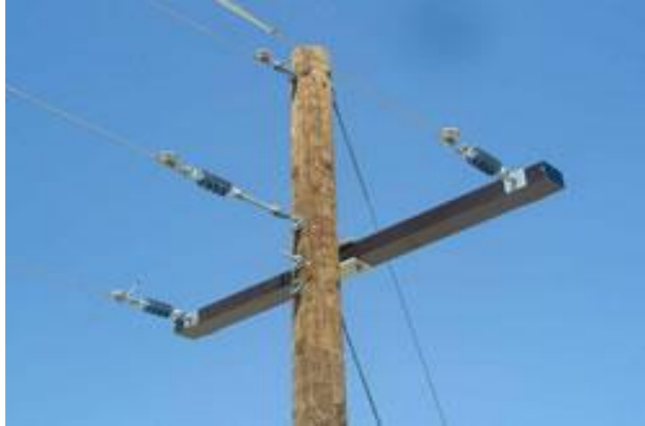
Figura 23. Poste de Madera
