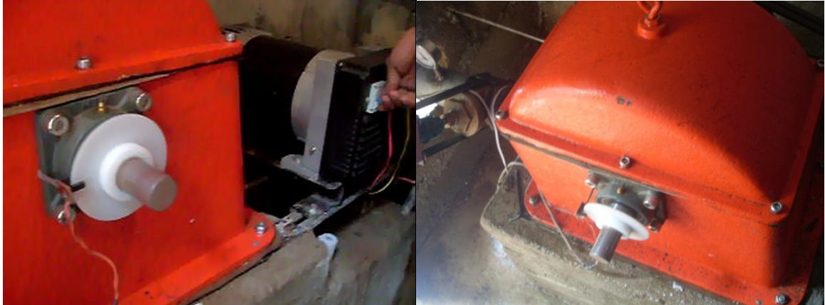
Figura 160. Instalación sensor óptico reflectivo
