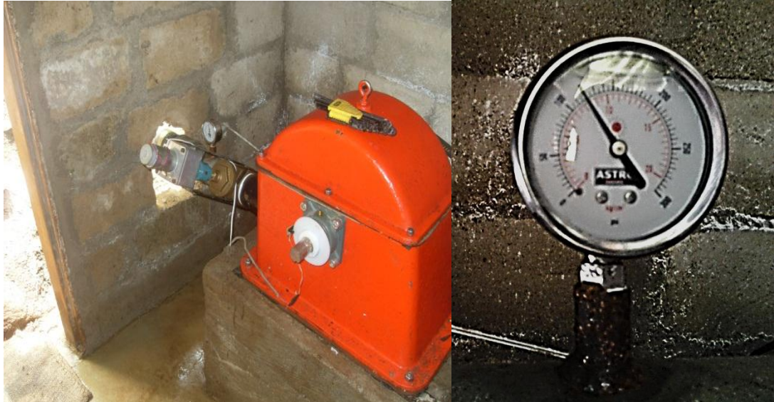
Figura 185. Medidor de presión en la entrada a la válvula.
