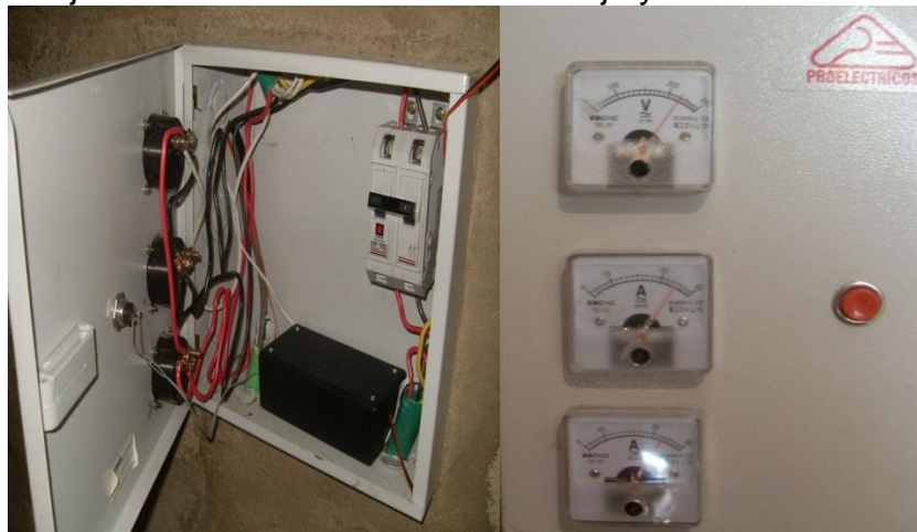
Figura 187. Caja de control + medidores de voltaje y corriente
