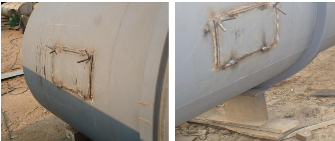
Figura 69. Compuertas de inspección.
