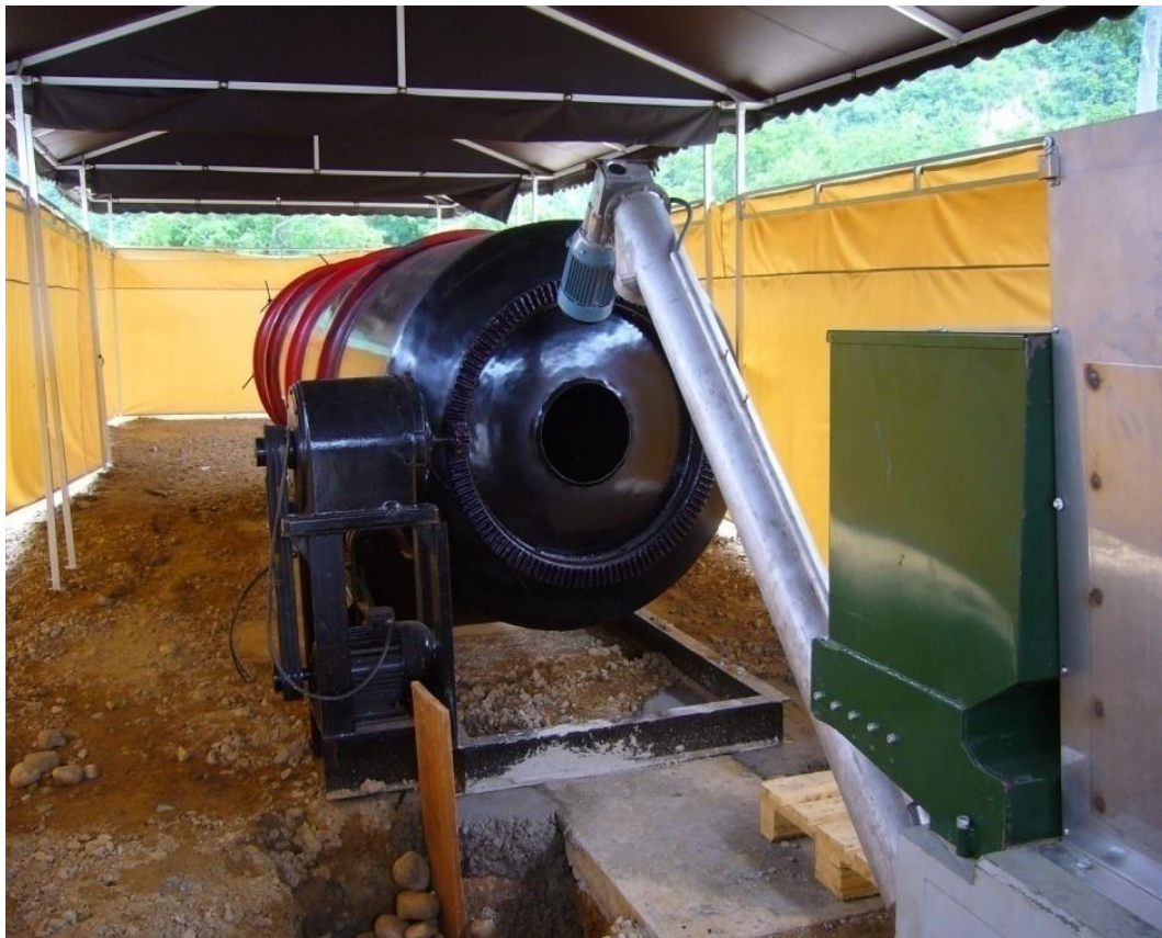
Figura 92. Anclaje del tanque bioreactor.
