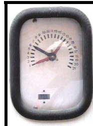
Figura 22. Indicador de posición del cambiador de tomas bajo carga.
