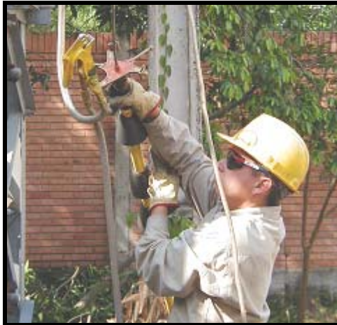
Figura 60. Vestimenta apropiada para labores de mantenimiento.
