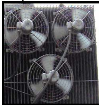
Figura 11. Ventiladores en disposición vertical. Transformador de 20 MVA.
