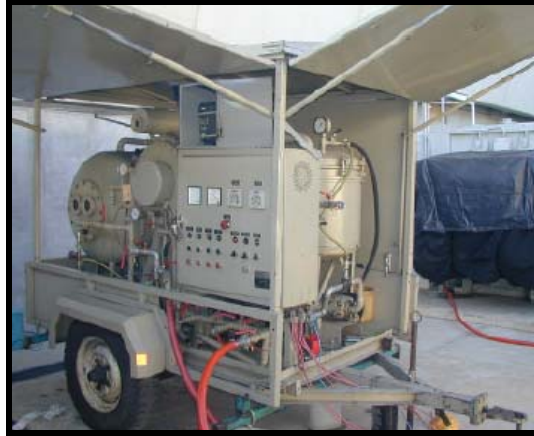
Figura 56. Equipo móvil de termovacío y filtrado de aceite
