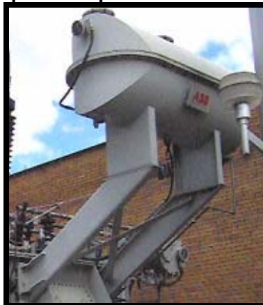
Figura 13. Tanque de expansión transformador 25 MVA.
