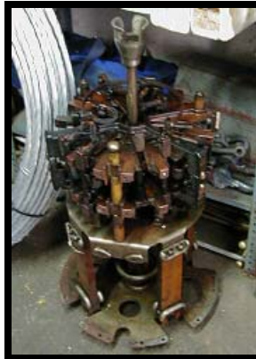
Figura 23. Cambiador de tomas bajo carga, desmontado.
