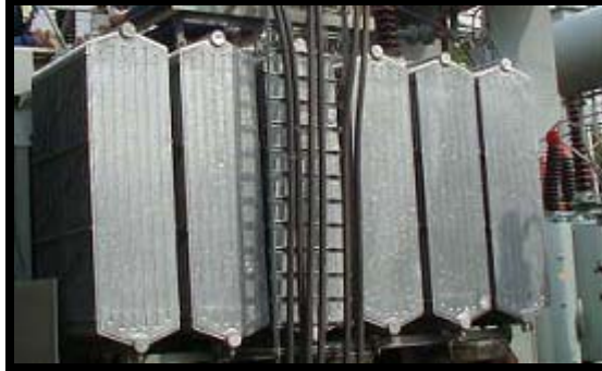
Figura 10. Radiadores. Transformador de 30 MVA.
