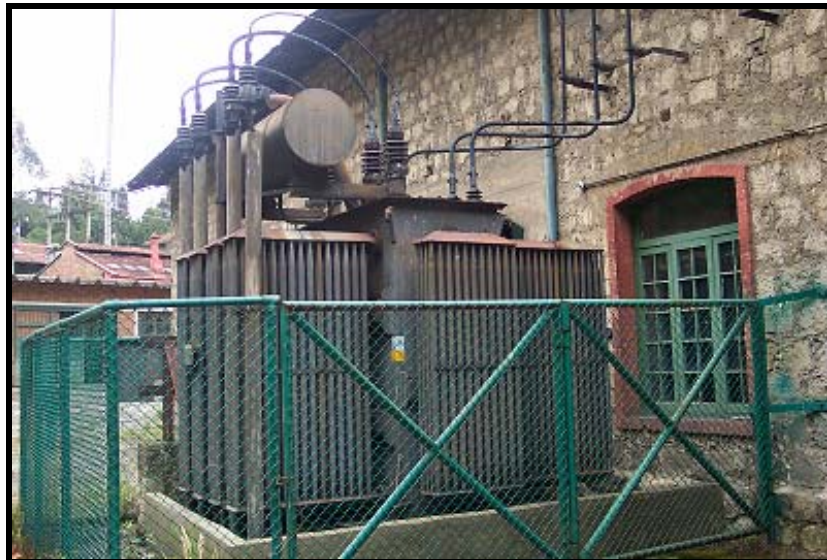
Figura 61. Transformador contaminado con PCB's
