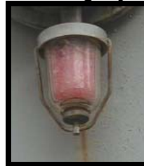
Figura 21. Deshumectador con silicagel y cobalto saturado de humedad.
