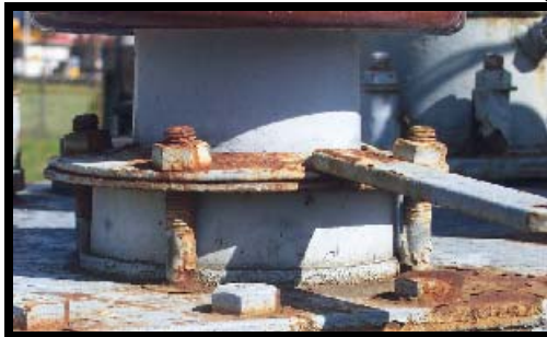
Figura 33. Pintura en avanzado estado de degradación.
