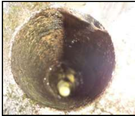
Figura 32. Evidencia fotográfica inspección del spool de tubería seleccionado para validación de la prueba
