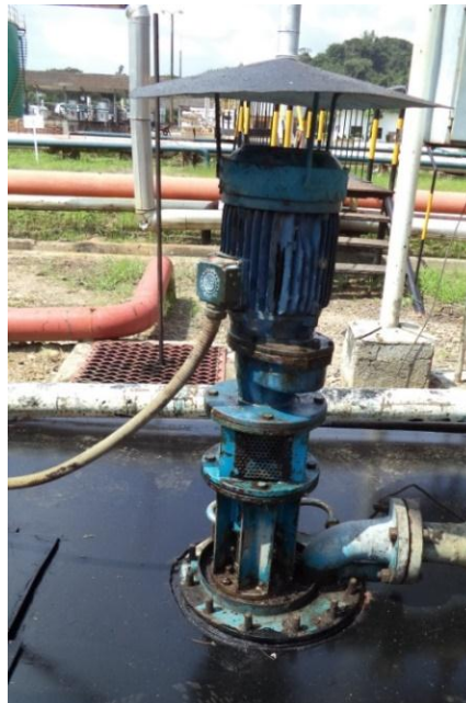
Figura 35. Unidad de bombeo Vertical PES a TK Trompo
