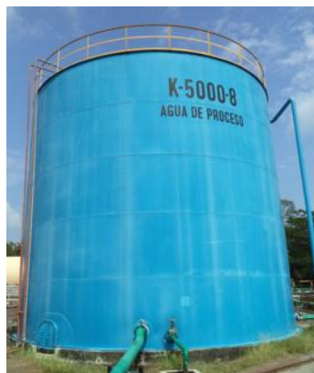
Figura 28. Tanque de Agua Filtrada TK 5000-8
