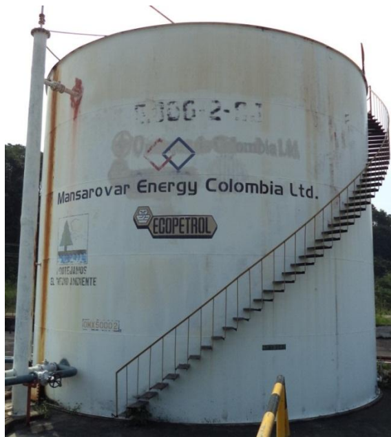
Figura 22. Tanque Desnatador TK 5000-2
