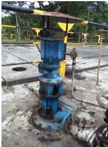
Figura 15. Unidad de Bombeo Vertical No. 1 Skimmer API
