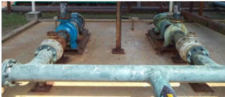
Figura 24. Unidades de Bombeo Transferencia a Filtros
