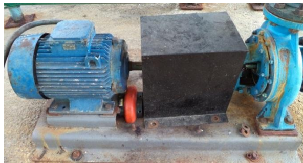
Figura 30. Unidad de bombeo Booster No.1
