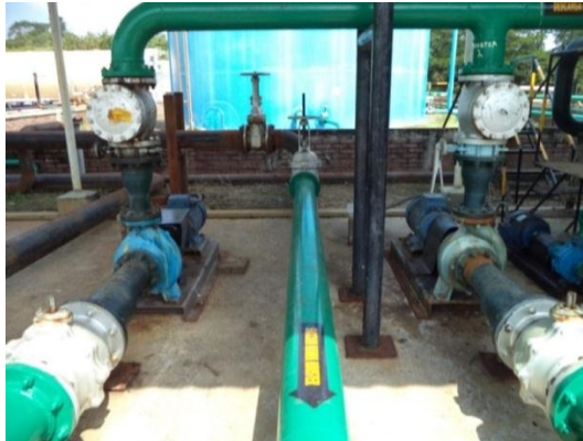
Figura 29. Unidades de bombeo Booster de Inyección
