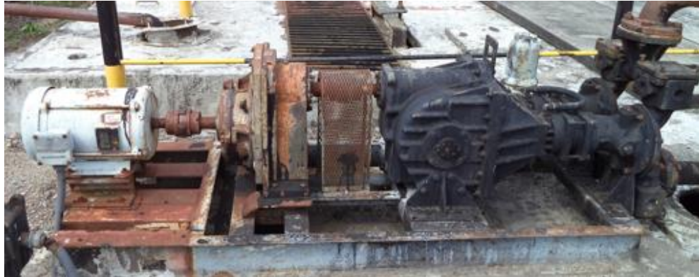
Figura 16. Unidad de Bombeo Horizontal No. 2 Piscina API
