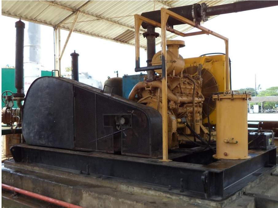
Figura 33. Unidad de bombeo No.1 Triplex Inyección a Pozos
