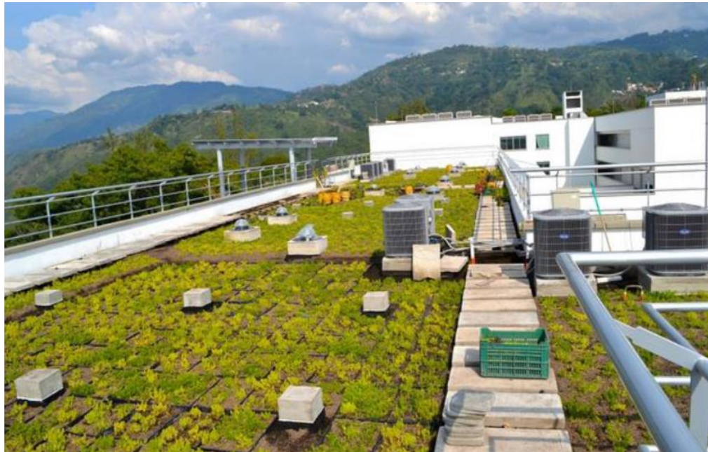
Figura 4. Tubos solares y cubiertas verdes Edificio Eléctrica [18]
