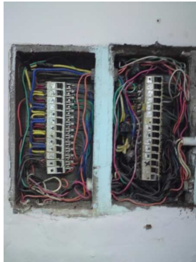
Figura 18. Imagen tableros TCB1 y TCB2
