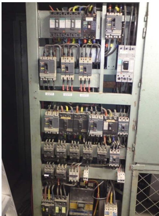
Figura 10 Imagen TGTM1 (subestación 225 kVA).
