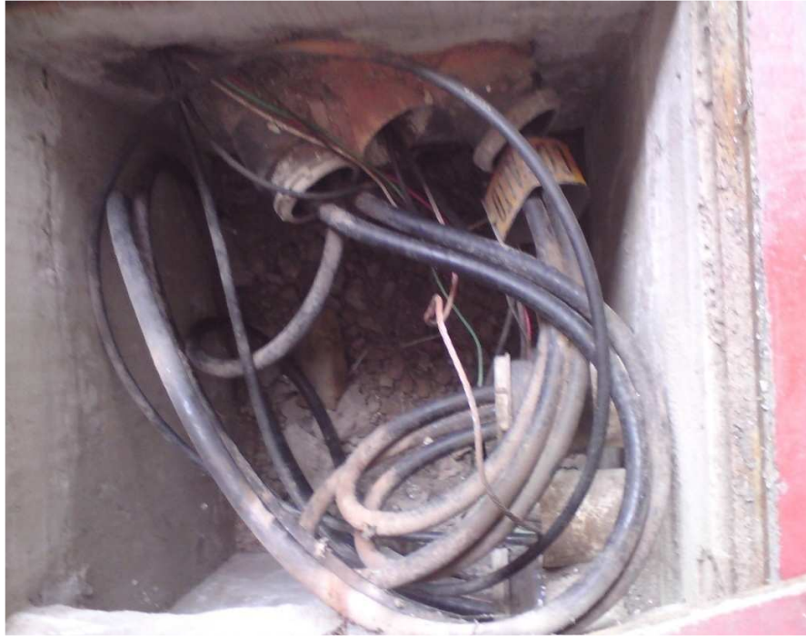
Caja de inspección #10. Primer piso Roberto Serpa
