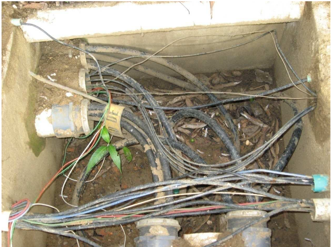
Caja de paso #19. Conductores a diferentes niveles de tensió
