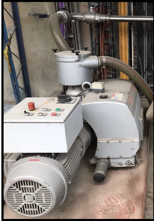
Figura 17. Bombas de vacío
