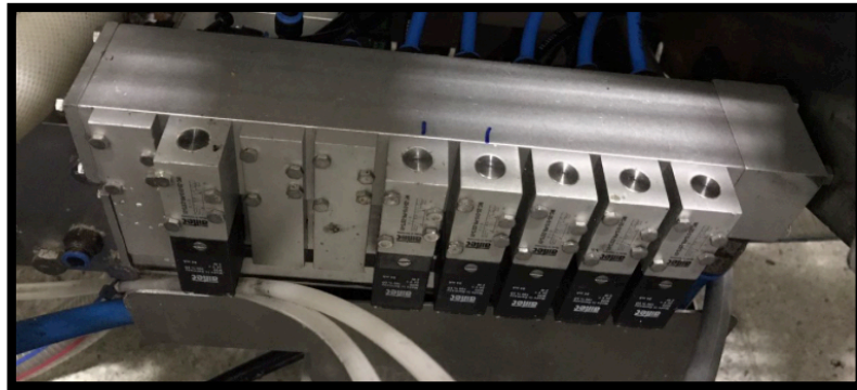
Figura 26. Bloque de Válvulas de vacío y Ventilación superior e inferior
