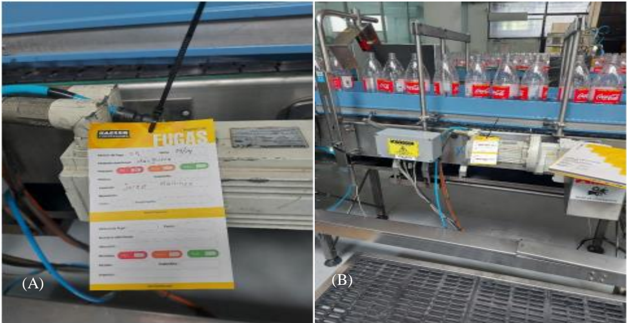
Registro de verificación. (A) Verificación, Corrección línea 2; (B) Ubicación, Entrada motor Cronex (manguera).
