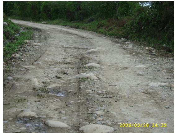
Figura 24. Estado Inicial (K6 + 000)
