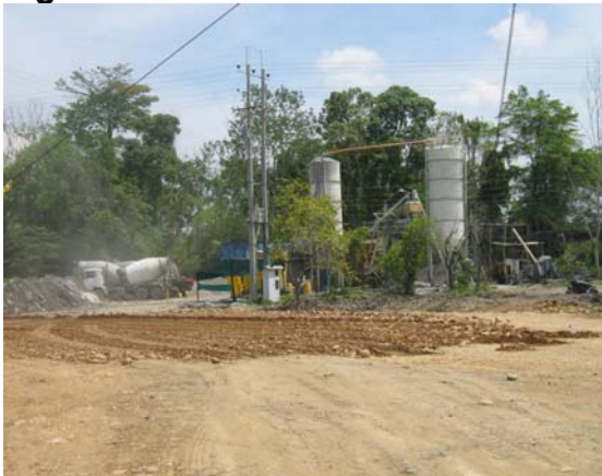
Figura 99. Planta de Concretos
