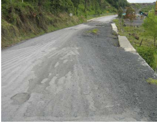
Figura 109. Fallas muros de contención
