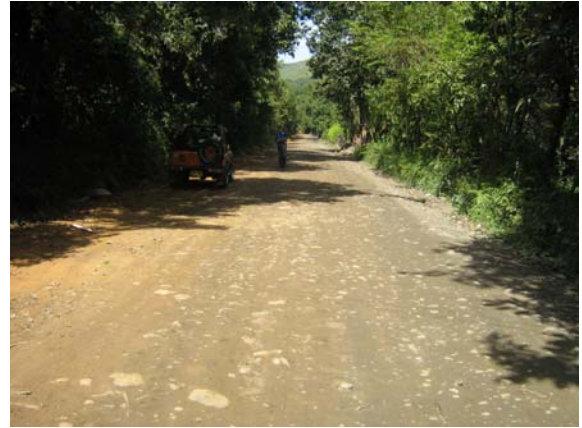
Figura 30. Detalle Vía (k8 + 500)
