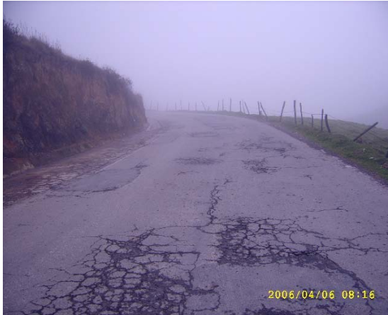
Figura 121. Fallas estructura de Pavimento
