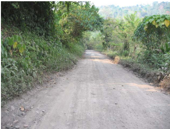
Figura 114. Estado de la vía
