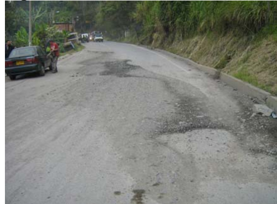
Figura 106. Presencia de fallos
