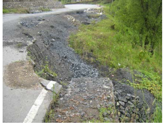
Figura 110. Pérdida de la banca
