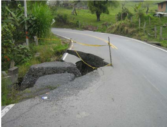
Figura 111. Fallo en el pavimento
