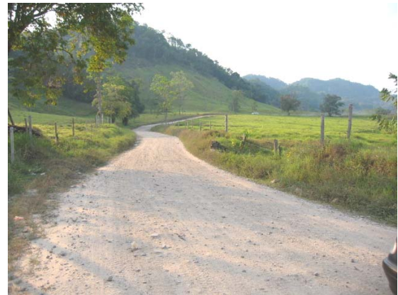
Figura 115. Estado de la vía
