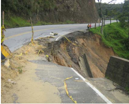
Figura 118. Pérdida de la banca K19 + 800
