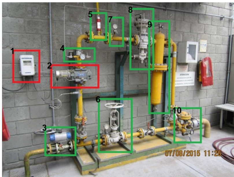
Ilustración 3. Estación de Regulación y Medición de Gas Natural Vehicular
