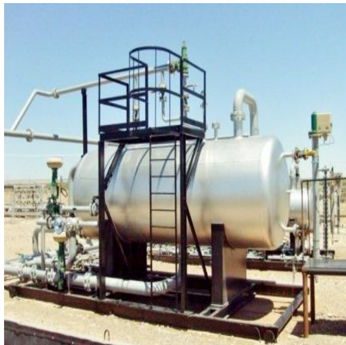
FIGURA 3. Separador de fluidos y gas
