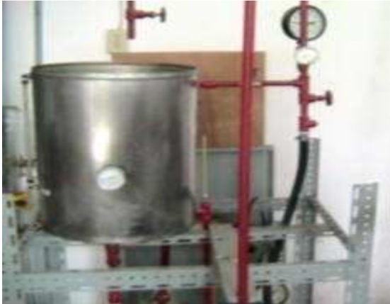
Figura 1. Batería de Calentamiento
