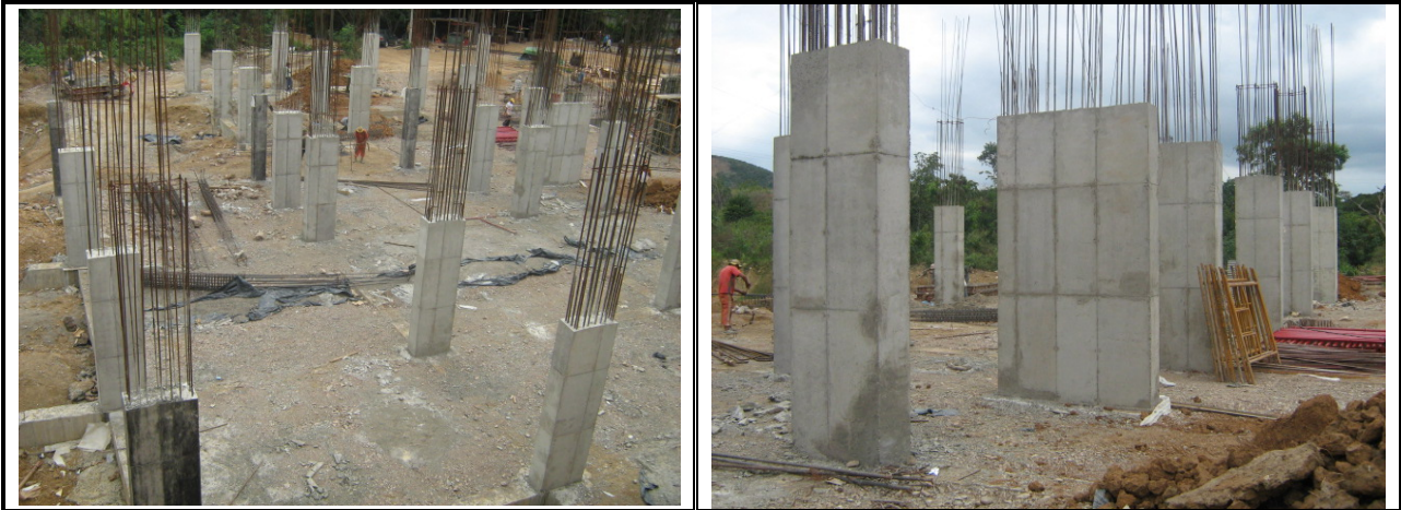
Figura No. 36. Acabados en la estructura (Columnas)
