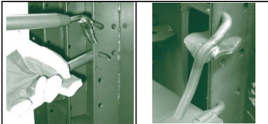
Figura No. 18. Instalación de la Grapa con la ayuda del tubo manual y un pico
