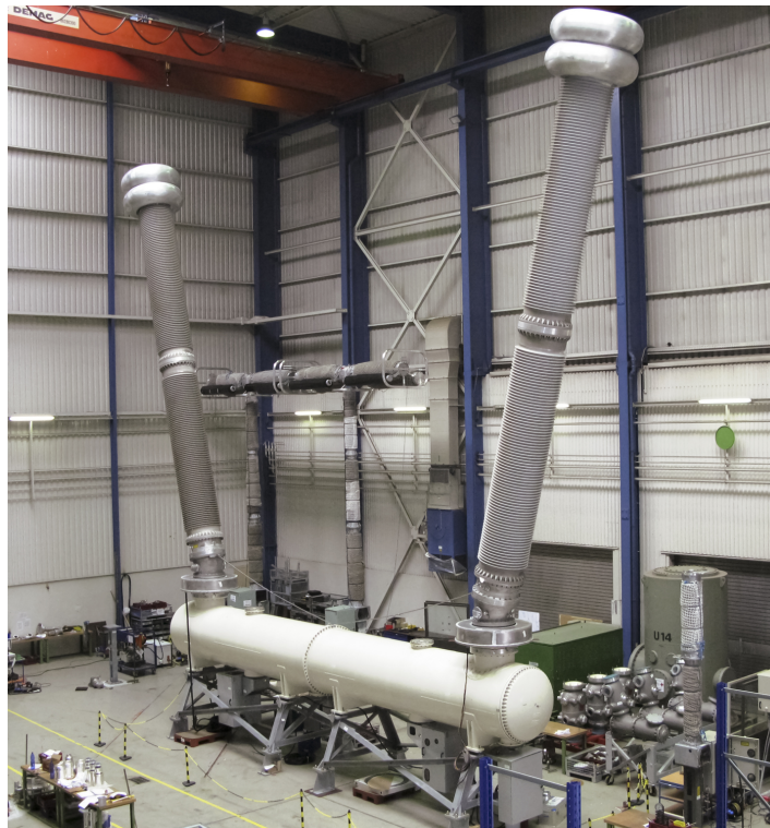
Figura 2.7.: Interruptor de 1200 kV. [6]
