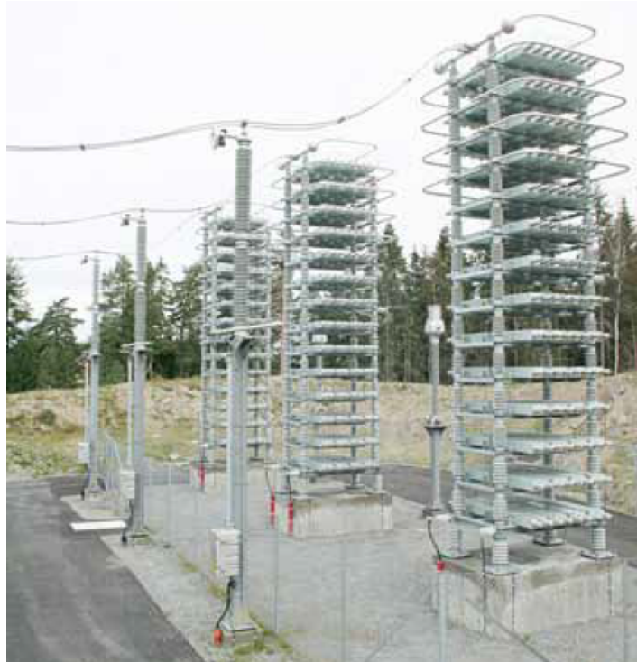
Figura 2.12.: Banco de capacitores 420 kV. [13]
