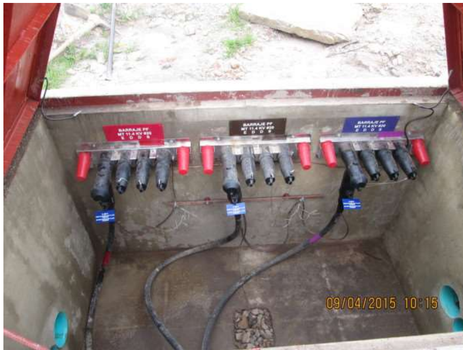
Figura 21. Conexión de derivación de conexión eléctrica subterráneos. Tomado de_: Infraestructura de ESSA
