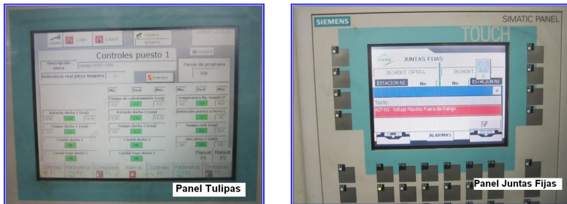
Figura 18. Paneles de Control Máquinas FDF (Juntas) y EFD (Tulipas)
