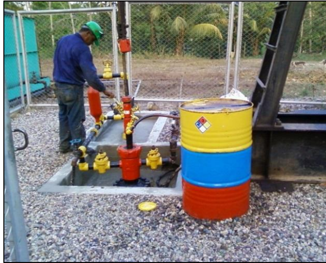
Figura 21. Procedimiento de recirculación de químico en pozo Colorado 44 del Campo Escuela Colorado.
