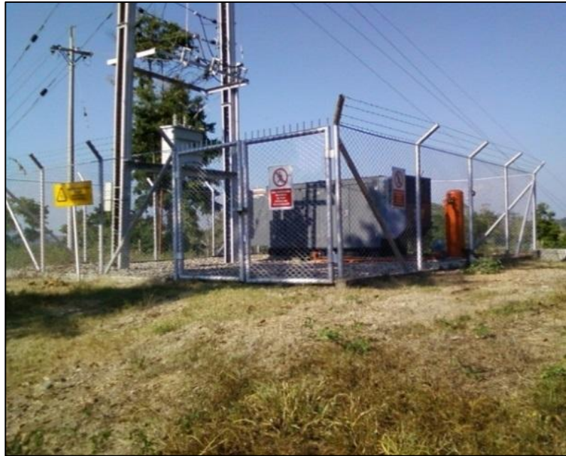
Figura 20. Sub-estación eléctrica 71 del Campo Escuela Colorado.
