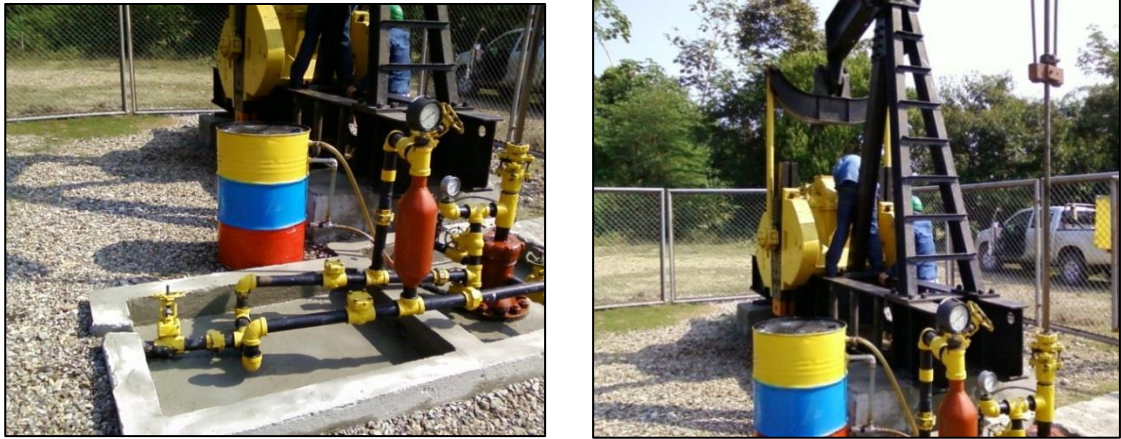
Figura 22. Mantenimiento al pozo Colorado 56 del Campo Escuela Colorado
