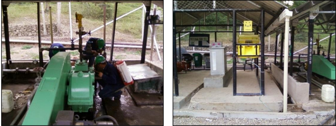
Figura 9. Bomba Reciprocante para bombeo de crudo.
