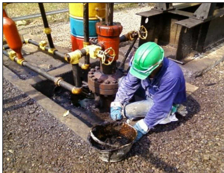
Figura 28. Limpieza del contrapozo por acumulación de residuos líquidos por producción del pozo Colorado 40.
