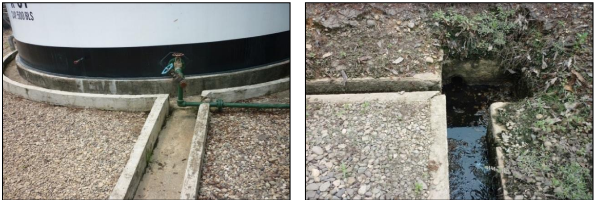
Figura 13. Cunetas para agua lluvia en los tanques de almacenamiento.
