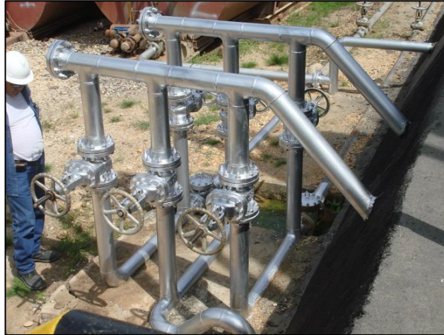
Figura 14. Múltiple de entrada a los tanques de recolección.
