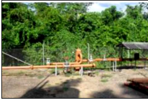
Figura 12. Sistema de líneas de flujo de gas.
