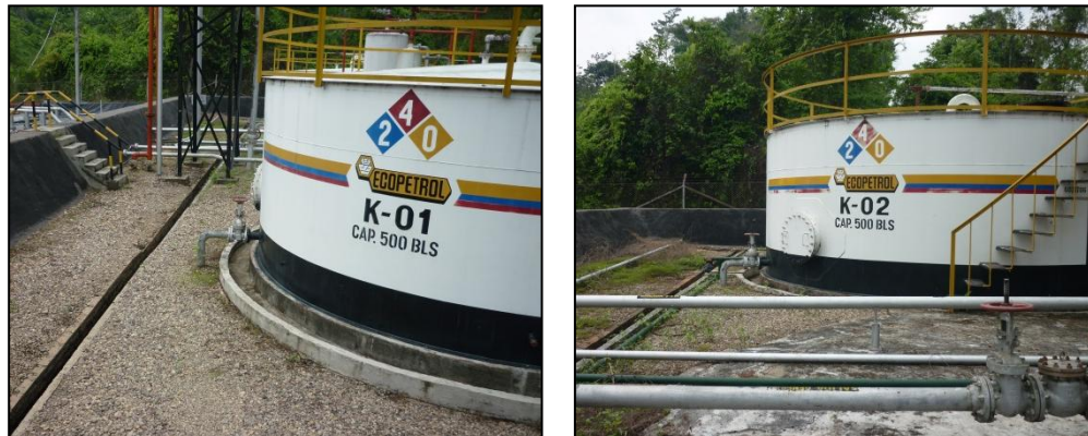
Figura 10. Tanques de Almacenamiento de Crudo.
