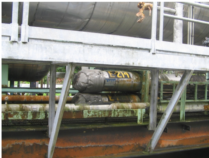
FOTOGRAFIA 5. INTERCAMBIADORES E214 Y E215
