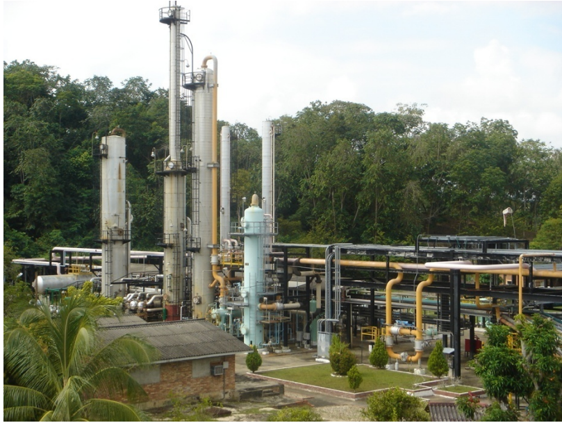
FOTOGRAFIA 1. PANORÁMICA DE LA PLANTA DE GAS EL CENTRO
