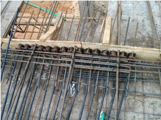
Figura 20. Detalle punto de salida de los cables
