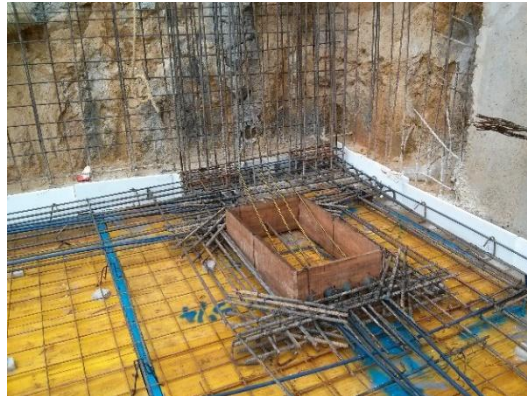
Figura 27. Detalle de caja de tensionamiento
