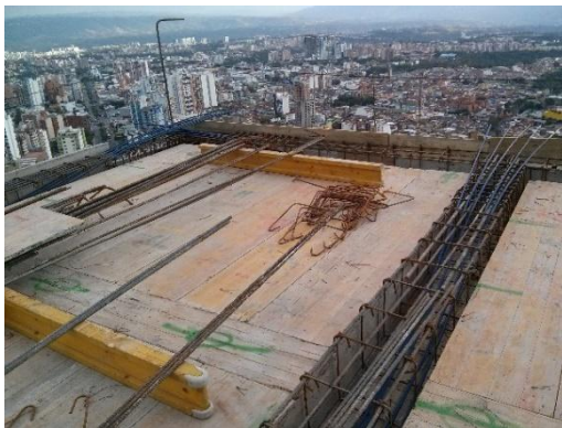
Figura 25. Proceso de armado de las vigas en el piso 39 de Green Gold
