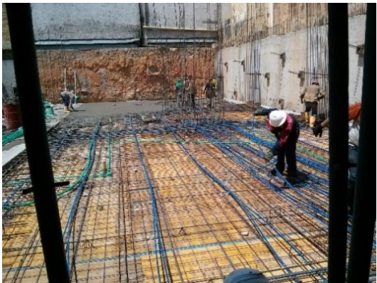
Figura 28. Colocación del postensado y fundida de los parqueaderos de Rosario Condominio II
