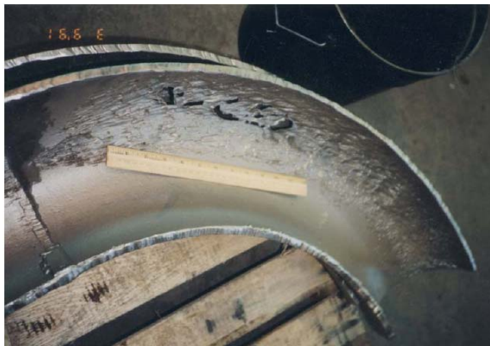
Figura 7. Corrosión por ácidos nafténicos en torres de destilación.
