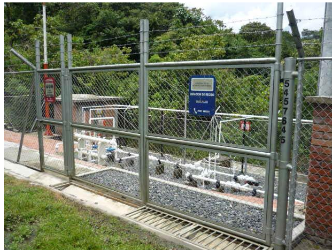
Estación de Recibo Bolívar
