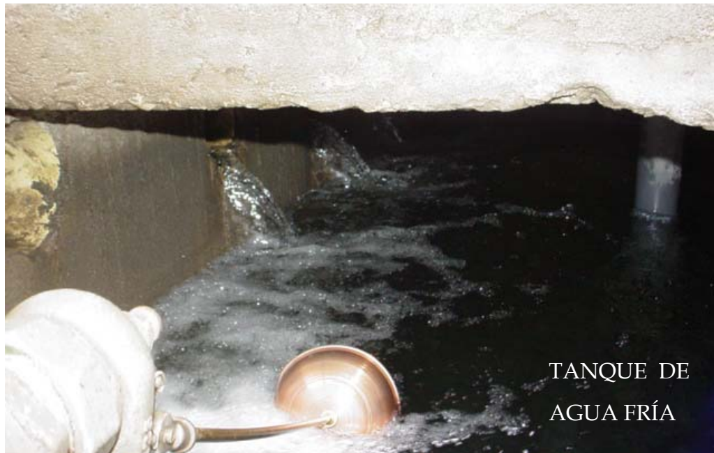
Figura 26. Rebose entre los tanques de agua
