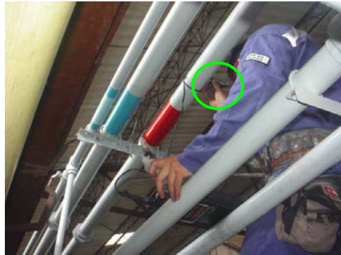
Figura 11. Sensor utilizado para medir el espesor de las tuberías
