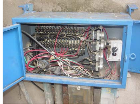
b. Caja de cables zona torre
