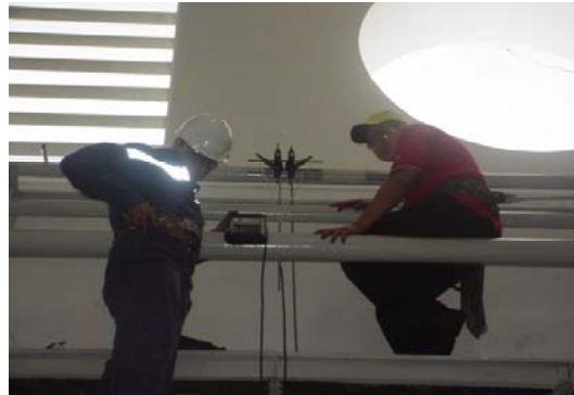
Línea de agua fría máquinas de temple, rectificadoras, horno, generador y secador
