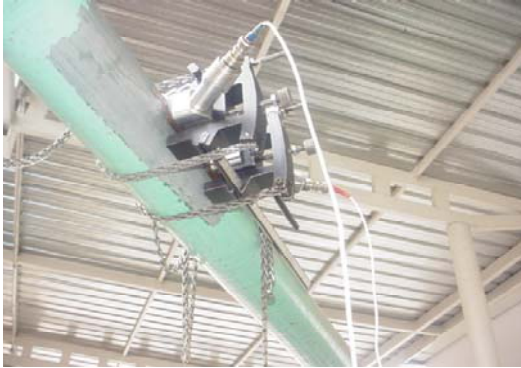
Línea de retorno máquinas de temple FDF y EFD, tornos Dubied, Detroit y TCT
