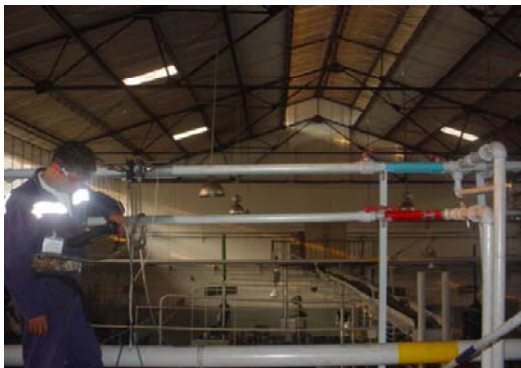
Línea de agua fría Maquina de vida
