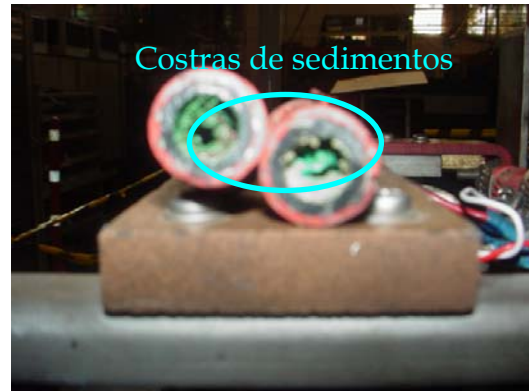
b. Mangueras de un intercambiador [Taponadas y gastadas]
