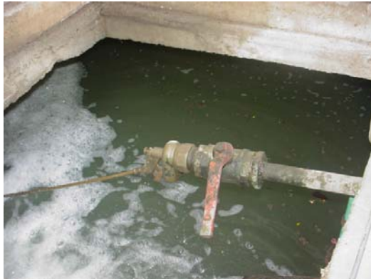
a. Tanque de agua fría
