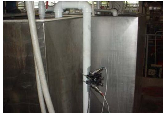
Línea de agua de enfriamiento del generador y transformadores de la máquina de temple EFD
