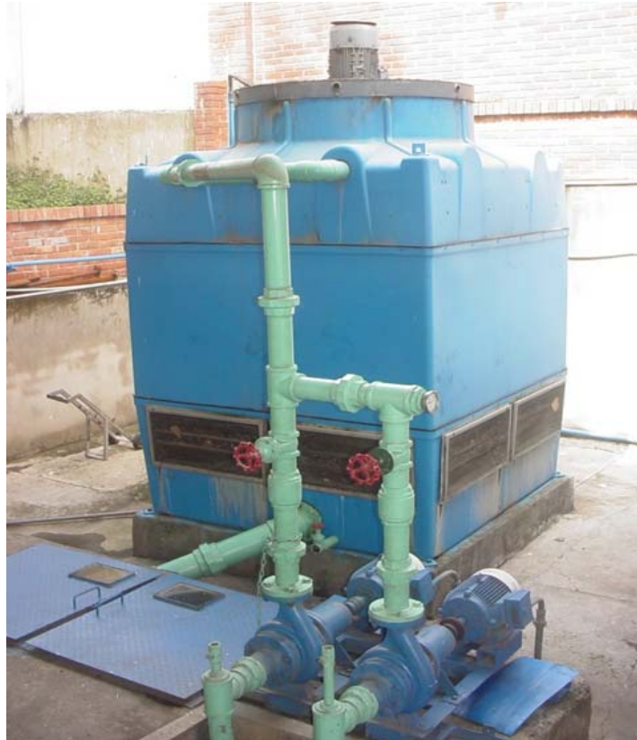
Figura 6. Foto de la torre de enfriamiento de la planta
