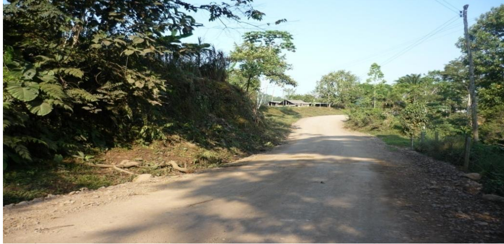
Descripción: Talud Inmediaciones del PR 36+850
