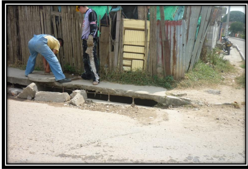
Fotografía No. 11. Inspección de sumideros Barrio Café Madrid - Fuente Torres Ing
