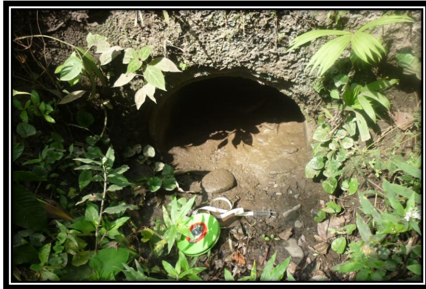
Fotografía No. 8. Alcantarilla colmata durante el inventario de obras y alcantarillas. Fuente el autor
