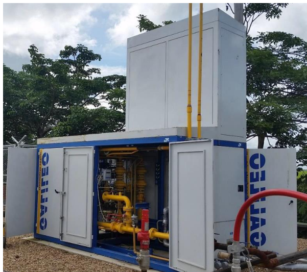
Figura 12. Unidad descompresora de Gas PRP.
