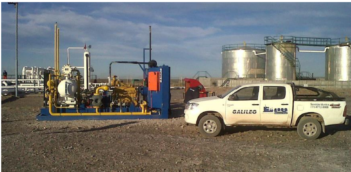
Figura 10. Estación de compresión en pozo.
