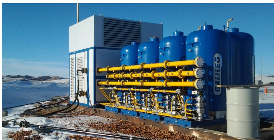
Figura 56. Planta ZPTS® de acondicionamiento de gas.
