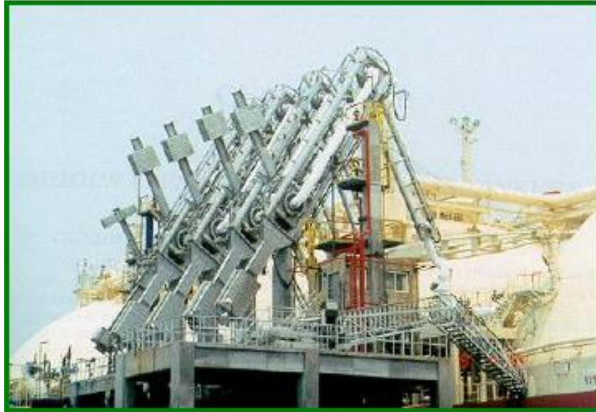
Figura 36. Brazos de descarga en un terminal de recibo GNL.
