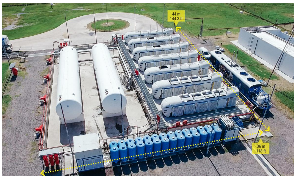
Figura 55. Planta de licuefacción de Buquebús en Argentina.
