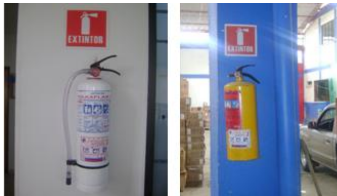
Figura 19: Equipo contra incendios.
