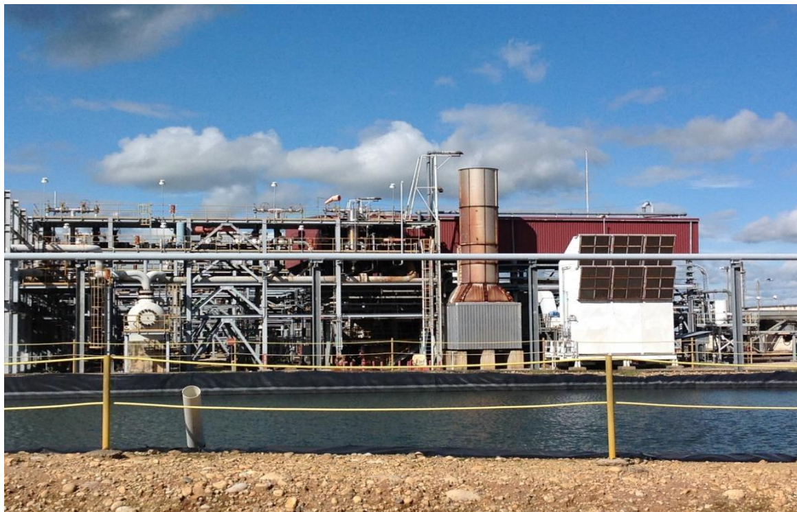
Figura 17. Tren de reinyección de gas
