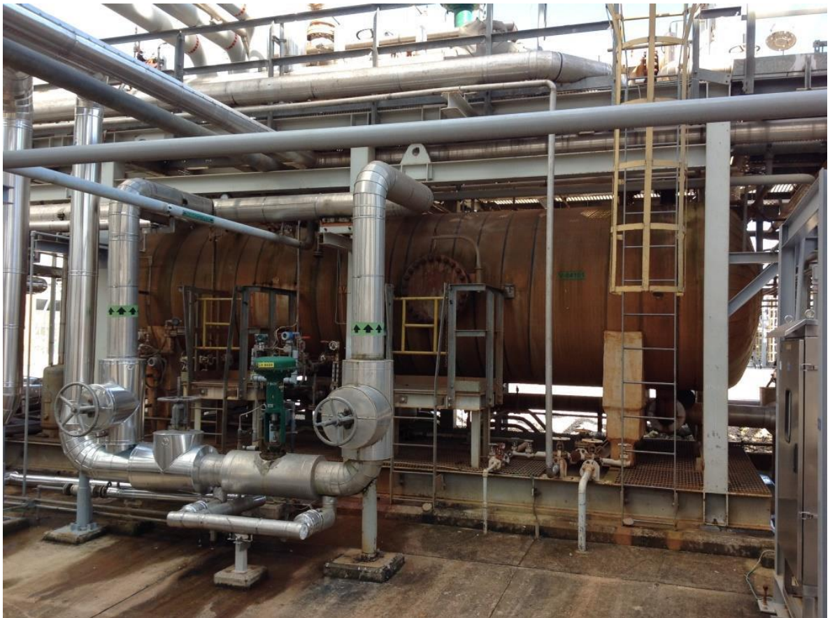
Figura 8. Flash drum de la Planta de GLP. V-84101
