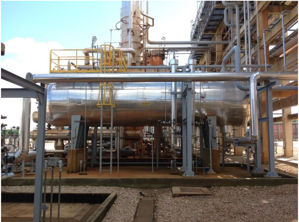
Figura 14. Flash drum adicional de la Planta GLP- V84103
