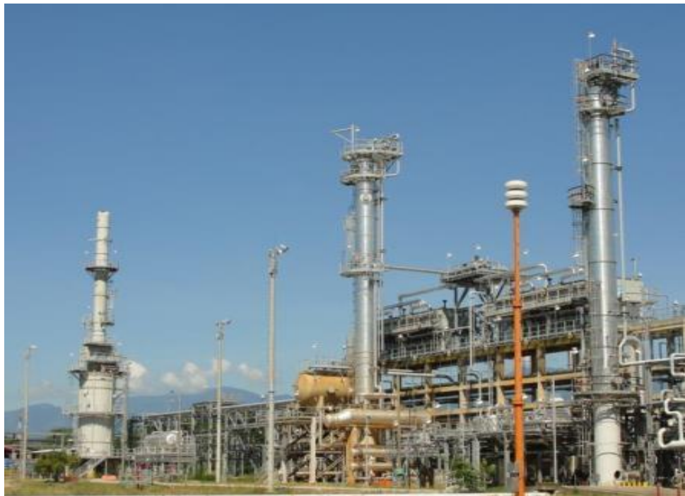
Figura 6. Planta de GLP y condensados
