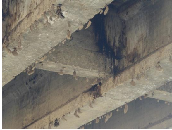
Figura 5. Fotografía de panales en la parte inferior de la estructura.
