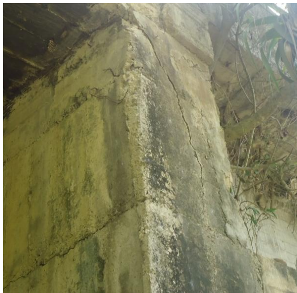
Figura 6. Fotografía de la pila central y falla del estribo
