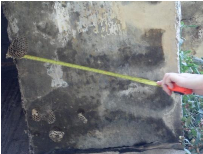
Figura 7. Foto de mediciones aproximadas del ancho de viga.
