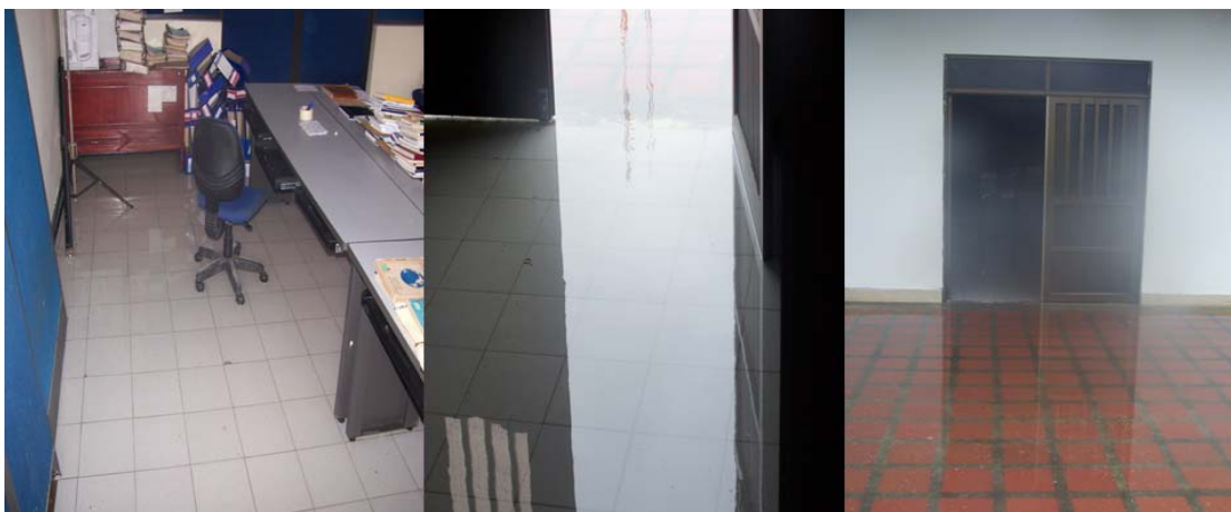
Figura 5. Efecto de las inundaciones por el pésimo estado del sistema de conducción del agua lluvia (canaletas) que atraviesa el depósito del archivo y la biblioteca.
