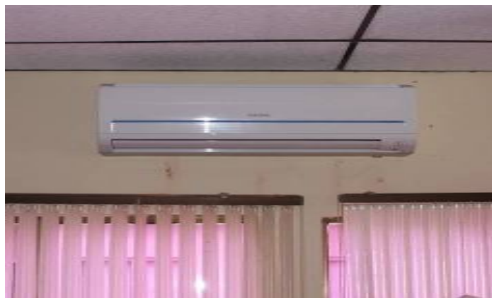
Figura 28. Sistema de aire acondicionado del Centro de Documentación DIMAR-CCCP.
