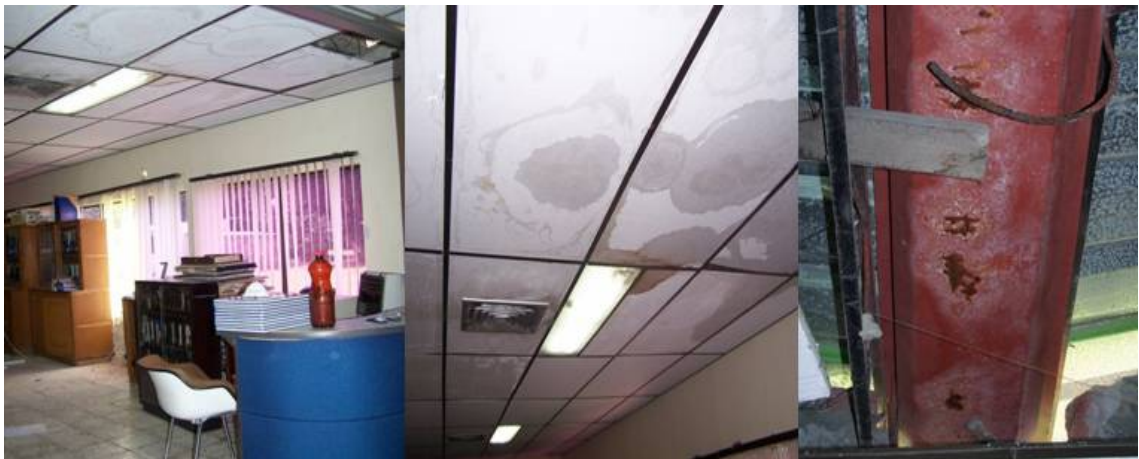
Figura 4. Panorámica interna del archivo. Deterioro del sistema de agua lluvia (canaletas).
