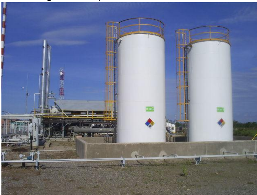
Figura 16. Tanques de almacenamiento de Nafta
