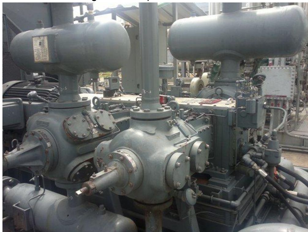
Figura 11. Compresores marca Ariel
