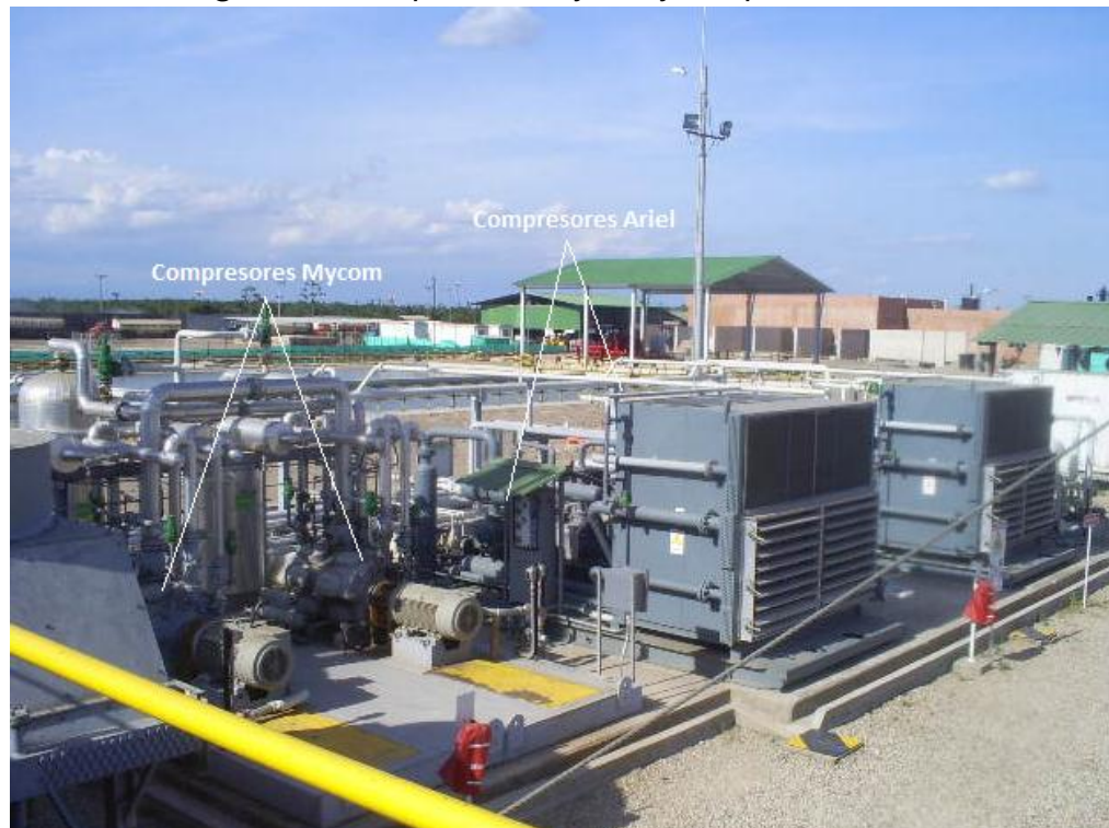
Figura 13. Compresores Mycom y compresores Ariel
