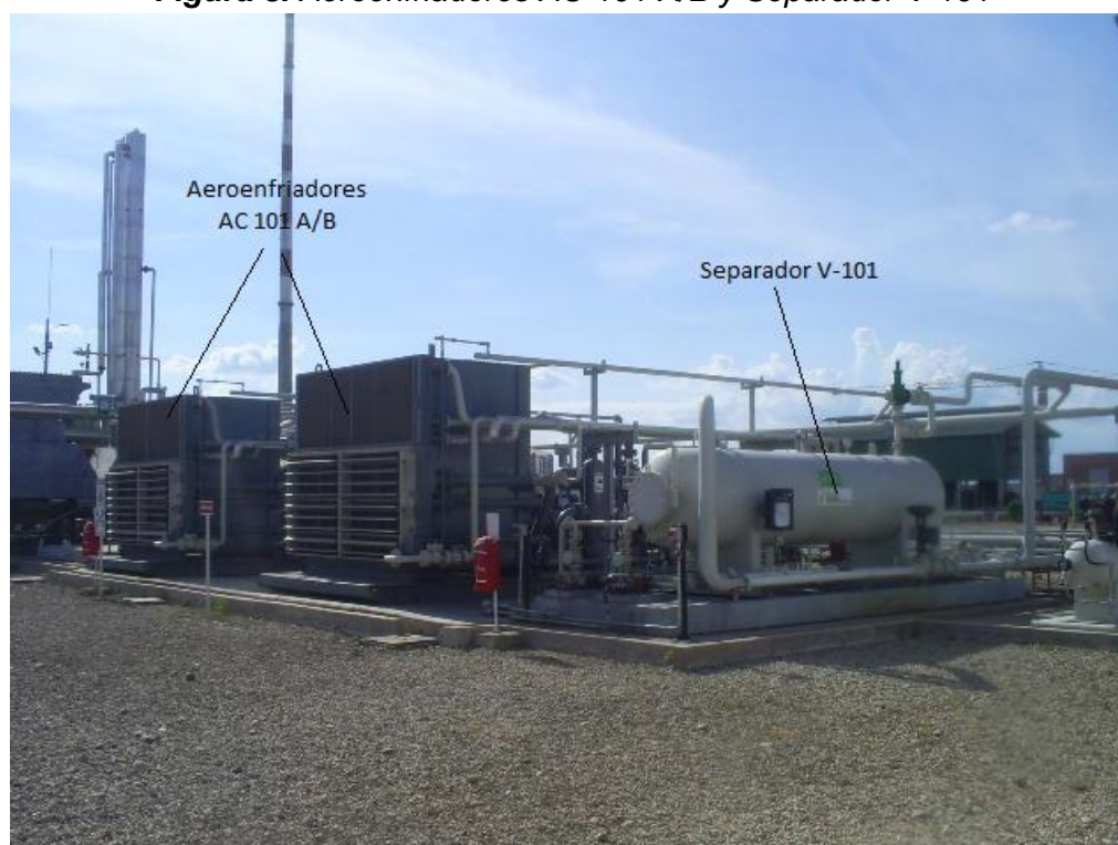
Figura 8. Aeroenfriadores AC-101 A/B y Separador V-101
