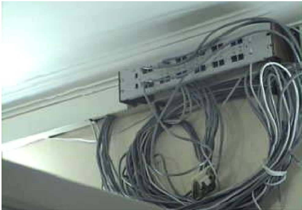
Figura 11. Cableado en el techo del edificio.
