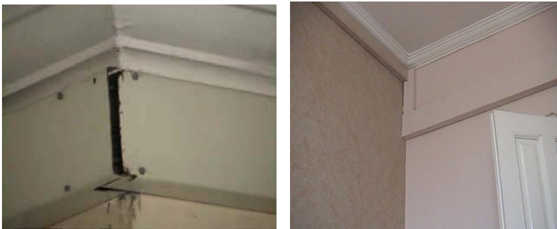
Figura 10. Uniones de Canaletas en Corrosión
