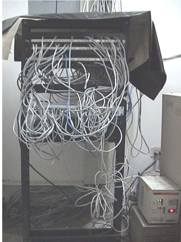
Figura 13. Central de Cableado.
