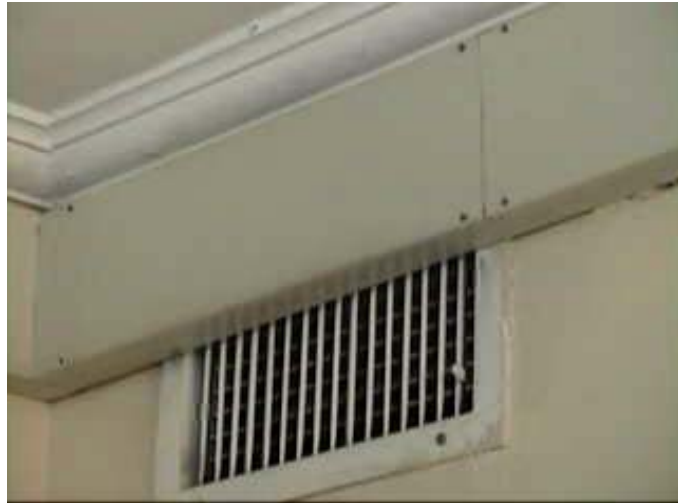
Figura 9. Canaleta sobre Ducto de aire Acondicionado.
