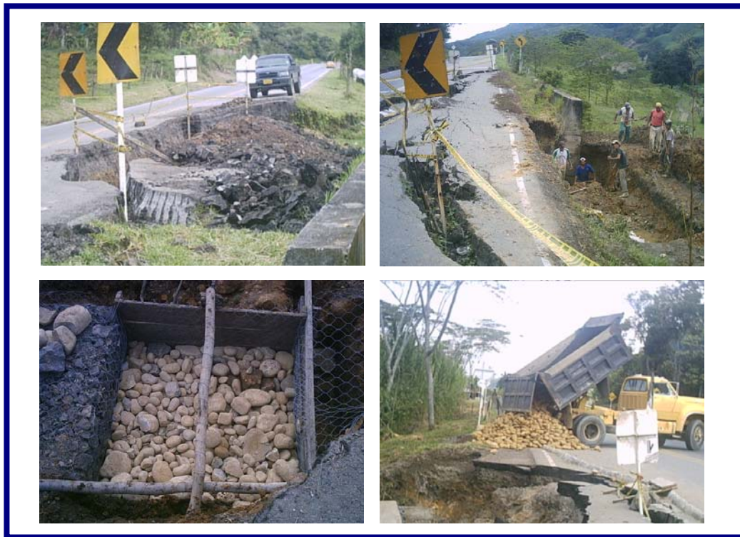
Fig. 15 Hundimientos sector Oiba-Socorro
