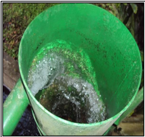
Imagen 11. Tanque De Mezcla Rápida
