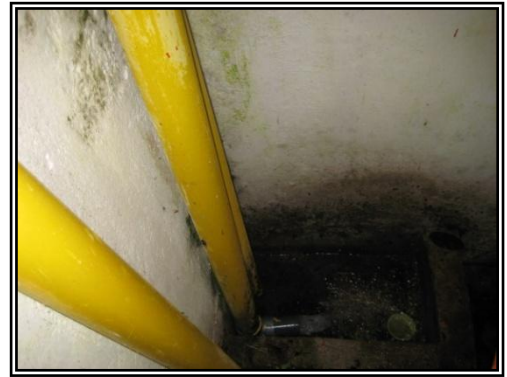
Imagen 15. Tubería De Excesos
