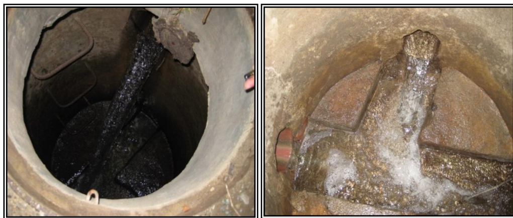
Imagen 6. Contaminación En EL Alcantarillado De Agua Captada
