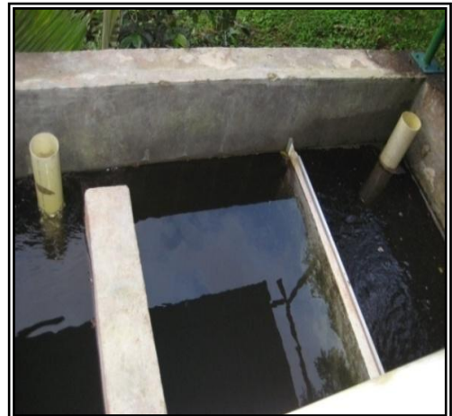
Imagen 12. Módulo De Floculación Y Sedimentación.
