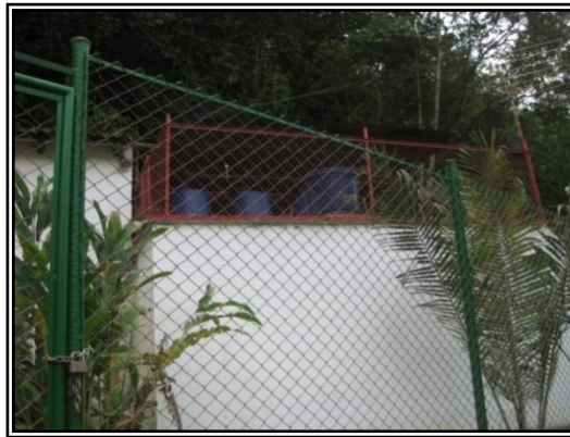
Imagen 20. Tanque De Almacenamiento
