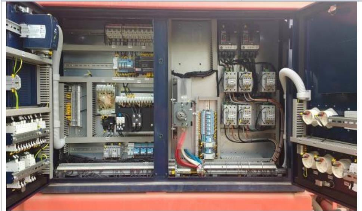
Figura 19. Gabinete eléctrico general
