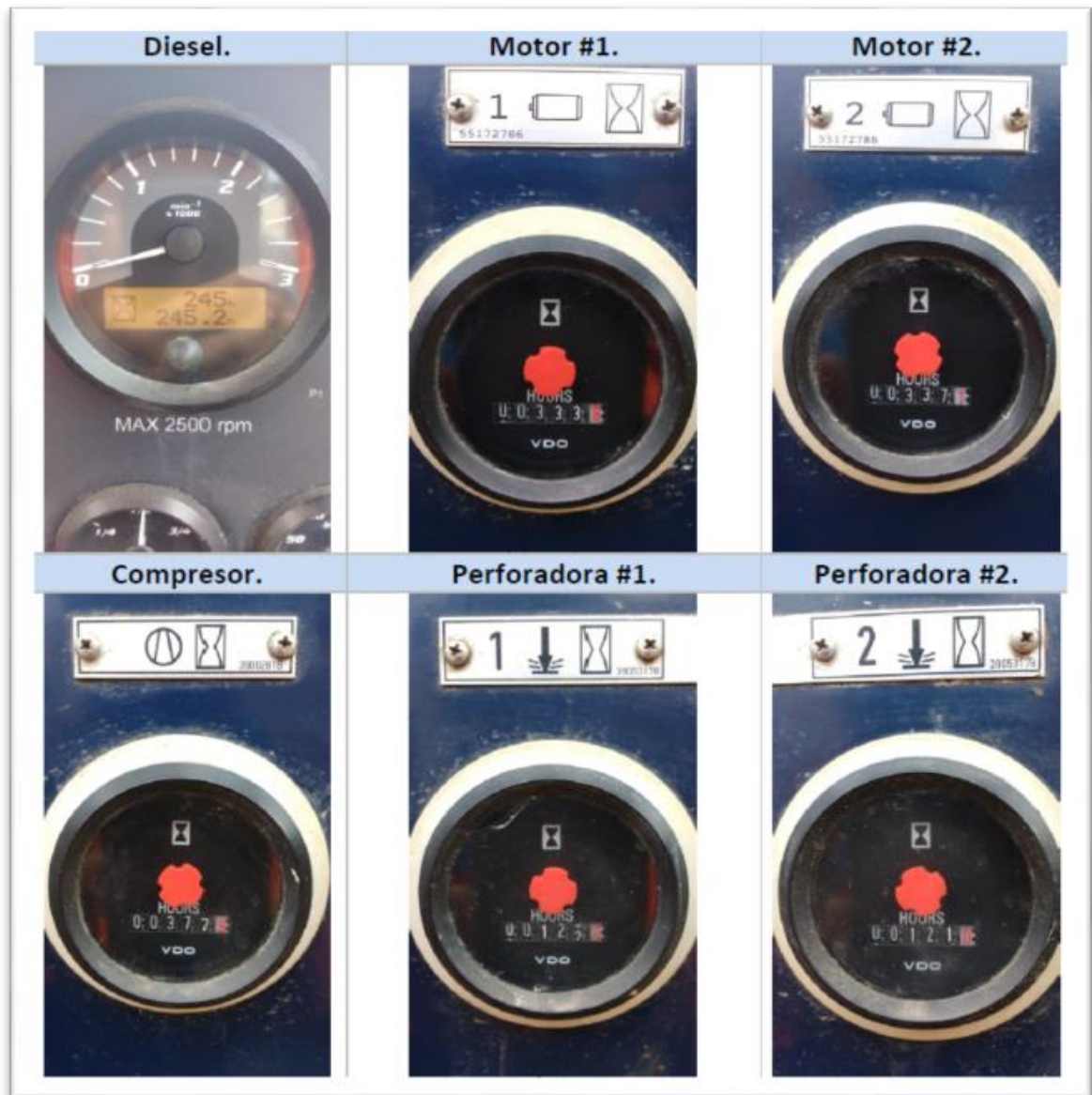
Figura 34. Cuadro de Horómetros de Subsistemas
