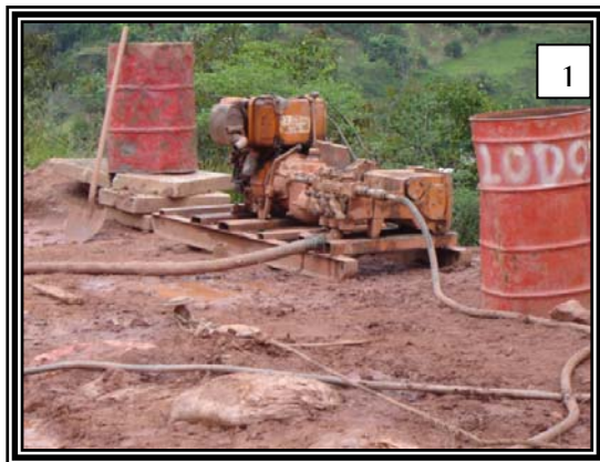
Figura 33. Ubicación de la motobomba
