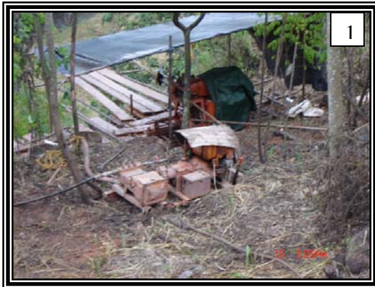
Figura 52. Ubicación de la motobomba
