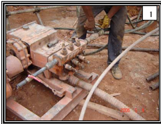
Figura 41. Acondicionamiento de la motobomba
