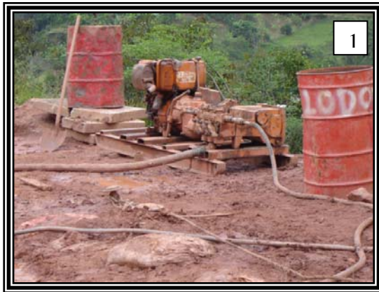
Figura 36. Adaptación de motobomba
