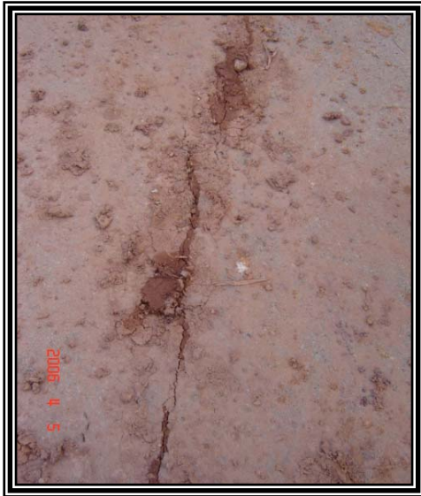
Figura 6. Grieta sobre el pavimento
