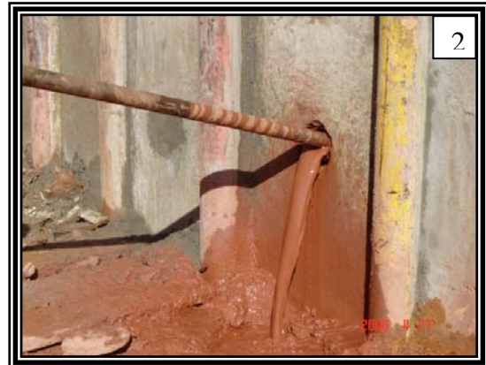
2. Detalle del punto de perforación. Se observa el lodo saliendo del punto y cayendo al canal.
