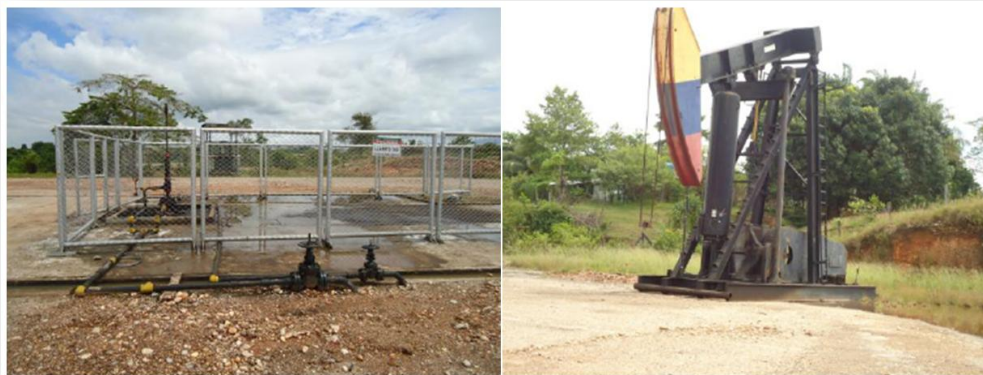
Figura 21. Unidades de Bombeo Mecánico Llanito 109
