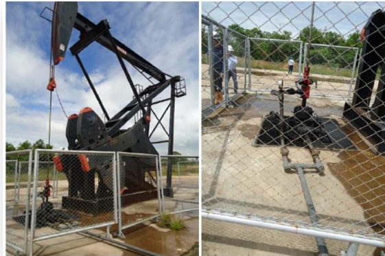
Figura 23. Unidades de Bombeo Mecánico Llanito 124
