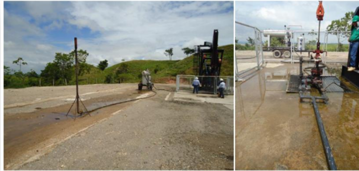
Figura 20. Unidades de Bombeo Mecánico Llanito 128
