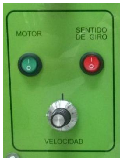
Figura 102. Controles de velocidad en el tablero del equipo.
