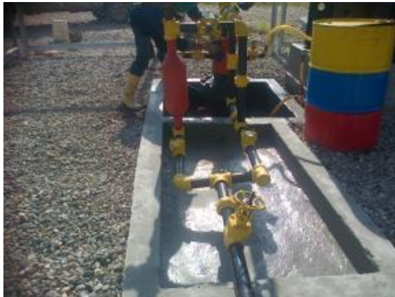
Figura 32. Sistema tanques ecológicos o colombianitos.
