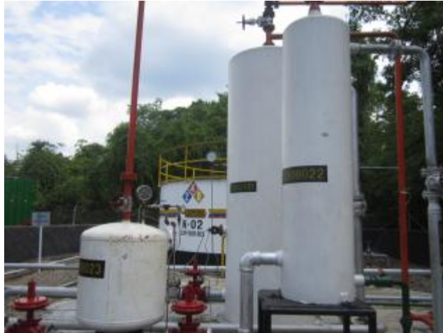
Figura 9. Separadores Estación Campo Colorado.
