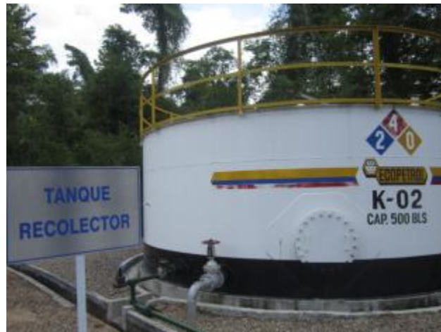
Figura 8. Tanques de Almacenamiento de Crudo.
