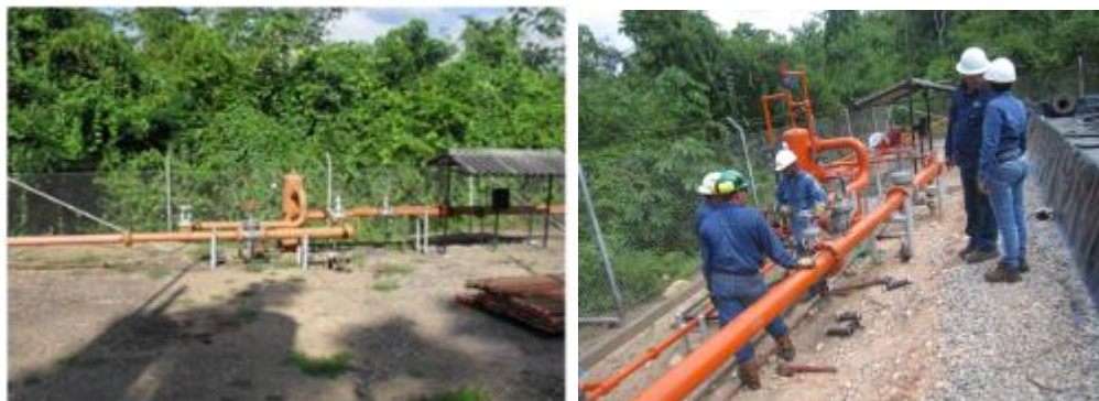
Figura 10. Sistema de tratamiento del gas Campo Colorado.
