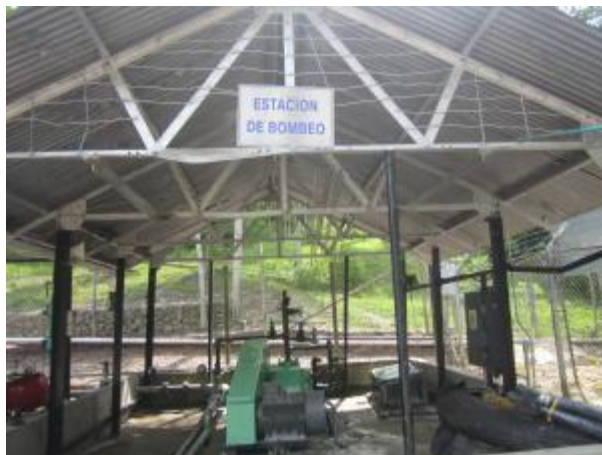
Figura 7. Bomba reciprocante de transferencia de crudo.
