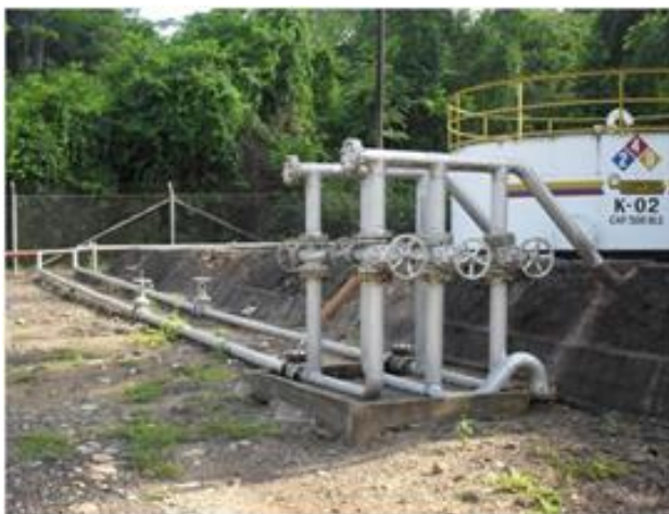
Figura 12. Múltiple de entrada de la Batería de Recolección CEC.
