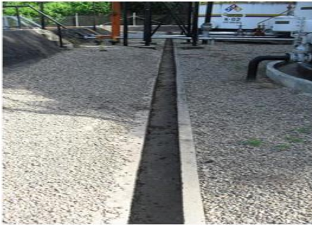
Figura 11. Cunetas de aguas lluvia de la Batería de Recolección CEC.
