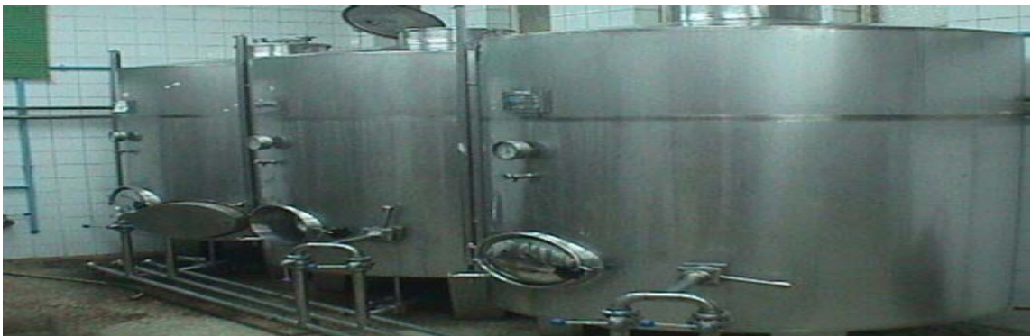
Figura20. Tanques de almacenamiento.
